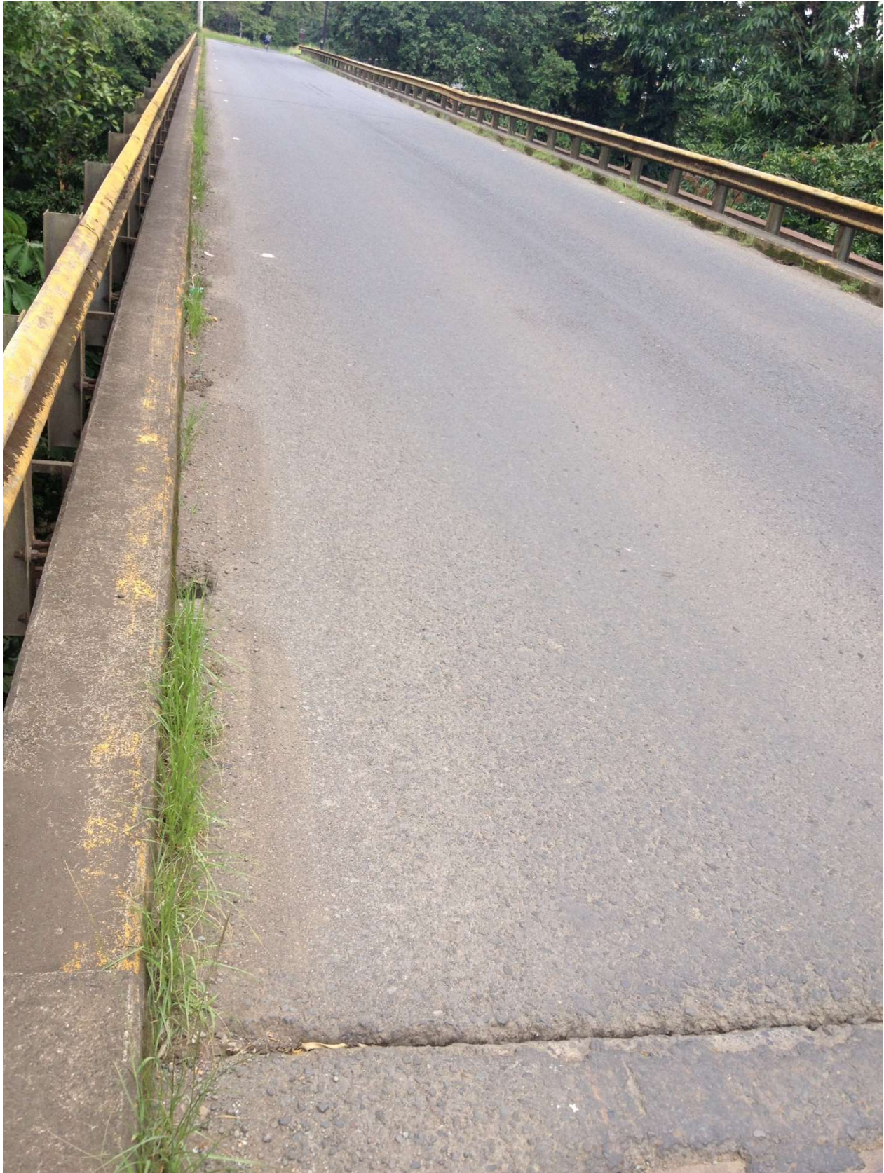
Losa del puente Sarapiquí previa intervención
