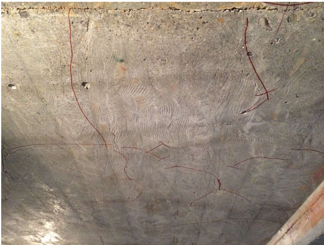
Mapeo de grietas de la losa por debajo (marzo 2015)
