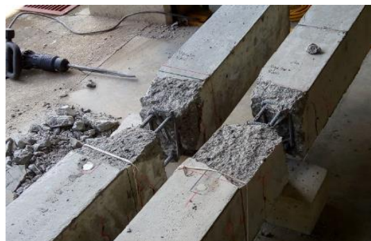
Figura 31: Corte de sección en vigas falladas para estudio visual.
