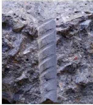
Figura 88: Huella de acero de refuerzo en viga de concreto con material vítreo
