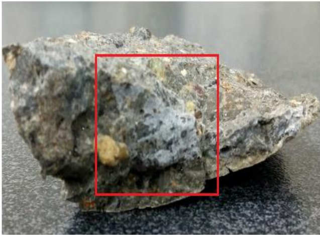
Figura 50: Mancha blanca superficial en el concreto hidráulico de vigas
