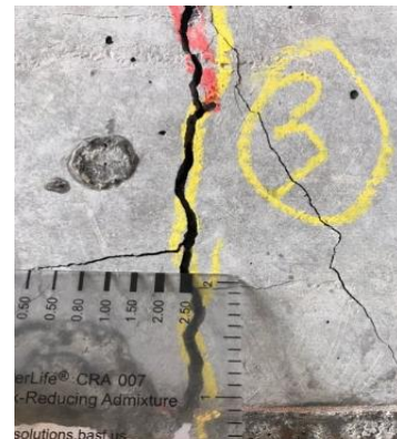
Figura 85: Grosor de grietas en viga de concreto con material vítreo
