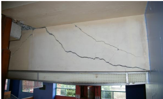
Figura 4. Daño en viga de entresuelo en entrada de escaleras principales. Hospital Monseñor Sanabria.
