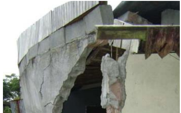
Figura 2. Ausencia de acero horizontal.
