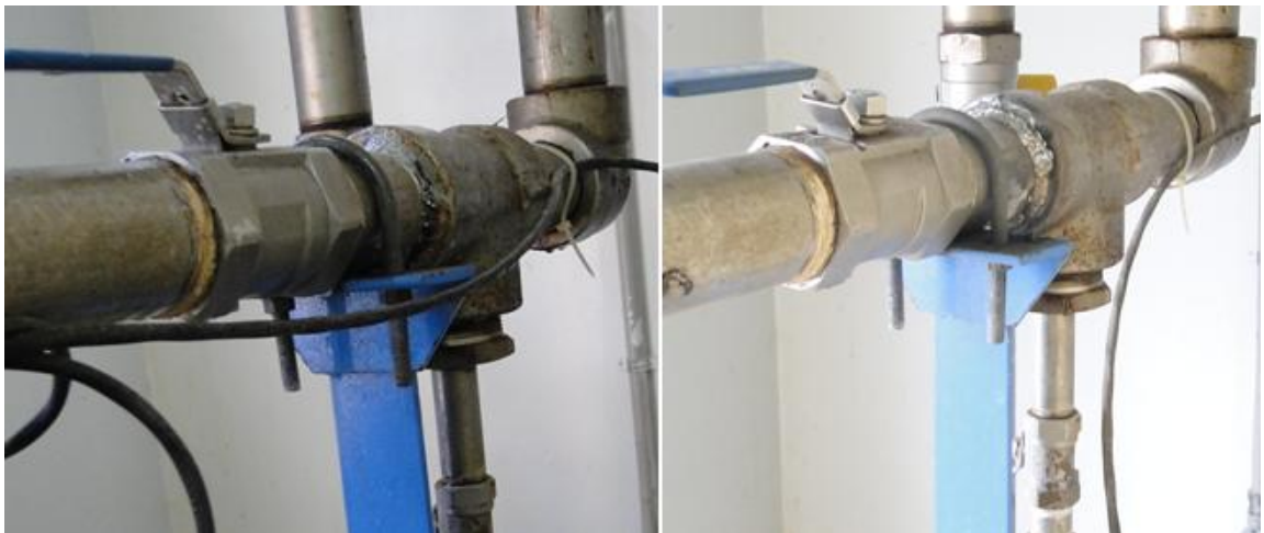
Figura II.2 Corrección de fuga en llave después de filtros
