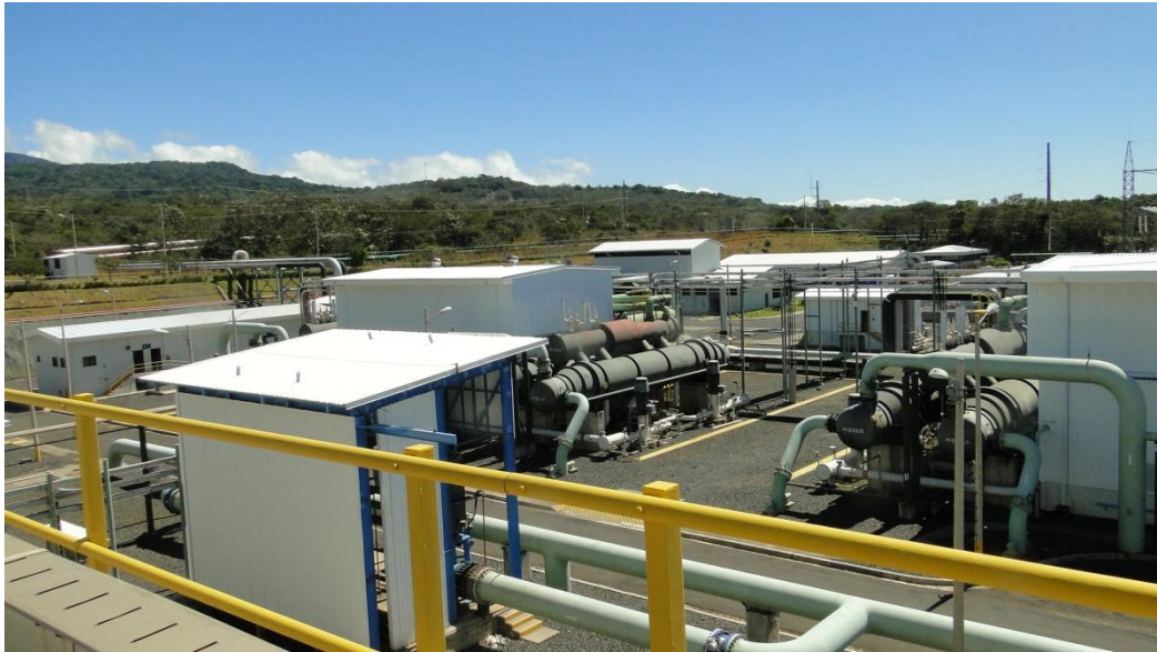
Figura 1.1 Planta Geotérmica Pailas I
