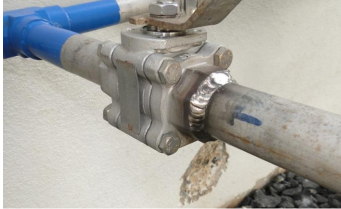
Figura 3.10 Fuga corregida con soldadura en llave de válvula de flujo mínimo de pentano
