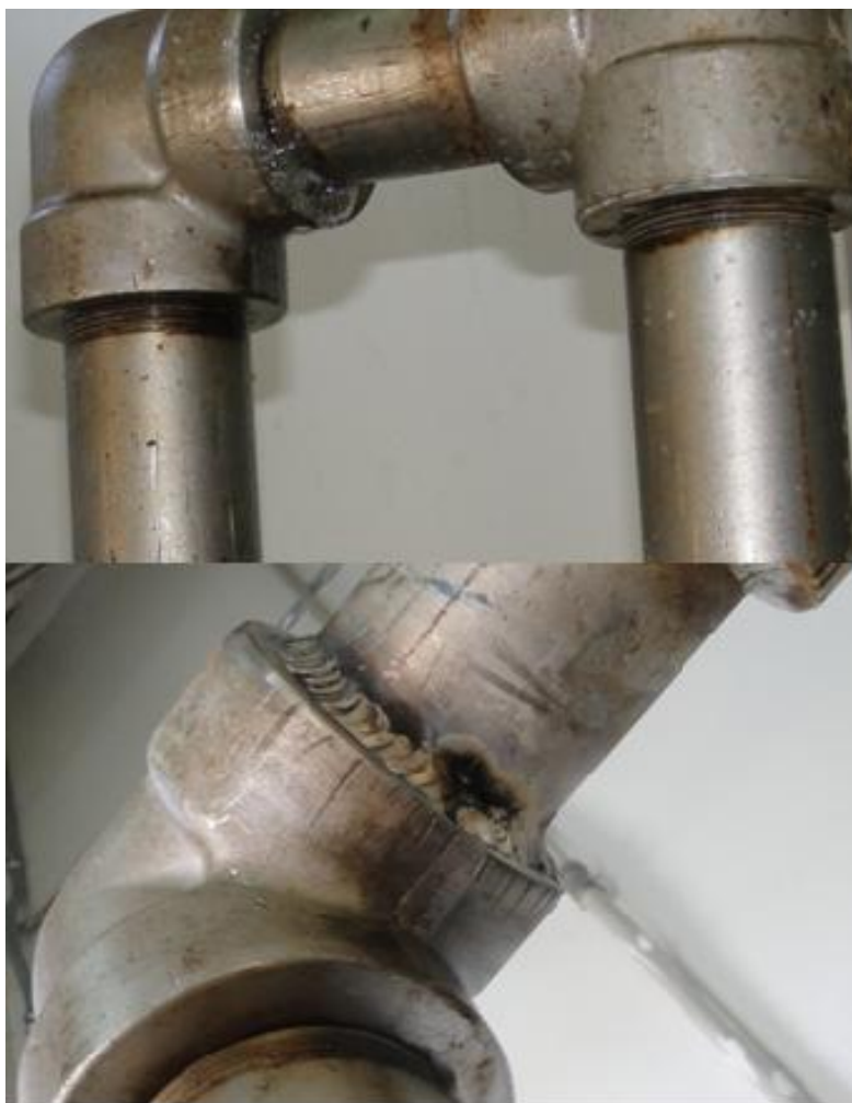
Figura II.5 Corrección de fuga en codo hacia salida del cuarto de compresores
