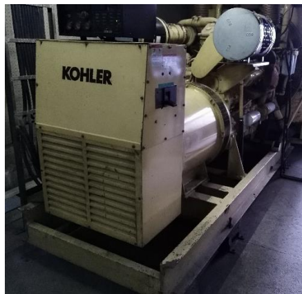
Figura 15. Planta generadora de emergencia marca Kohler.
