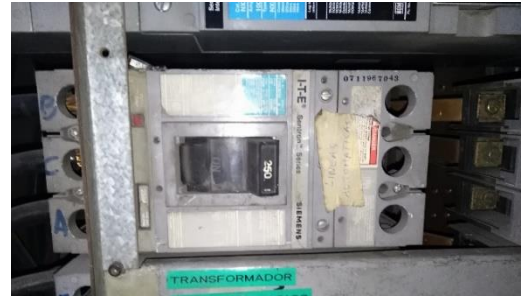
Figura 30. Interruptor de 'Líneas Automáticas'.
