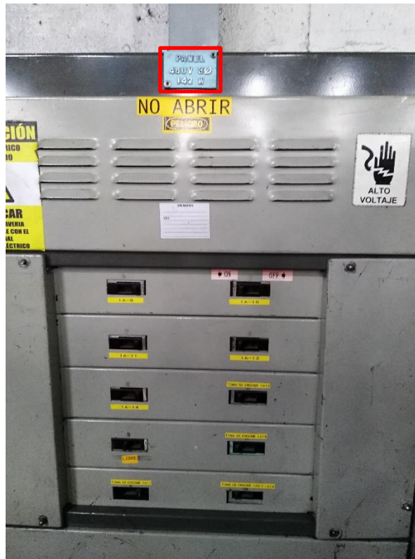
Figura 18. Etiquetado de los centros de carga para la base de datos.
