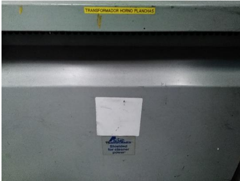
Figura 39. Transformador T17 sin datos de placa.
