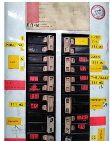
Figura 33. Etiquetado en paneles.
