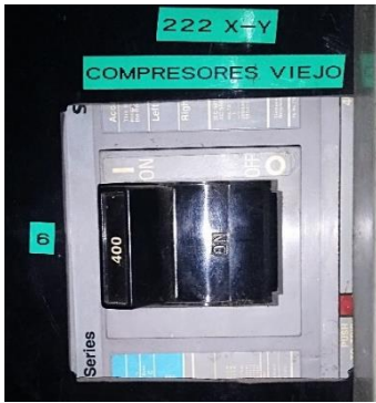
Figura 31. Interruptor mal etiquetado.
