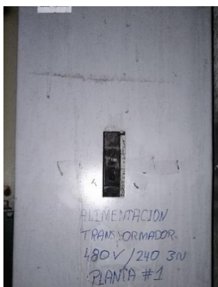
Figura 28. Interruptor en caja del transformador T1.
