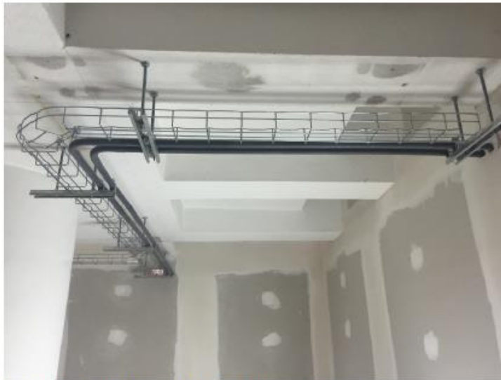
ESCALERILLA Y DUCTOS DE ELECTRICIDAD
