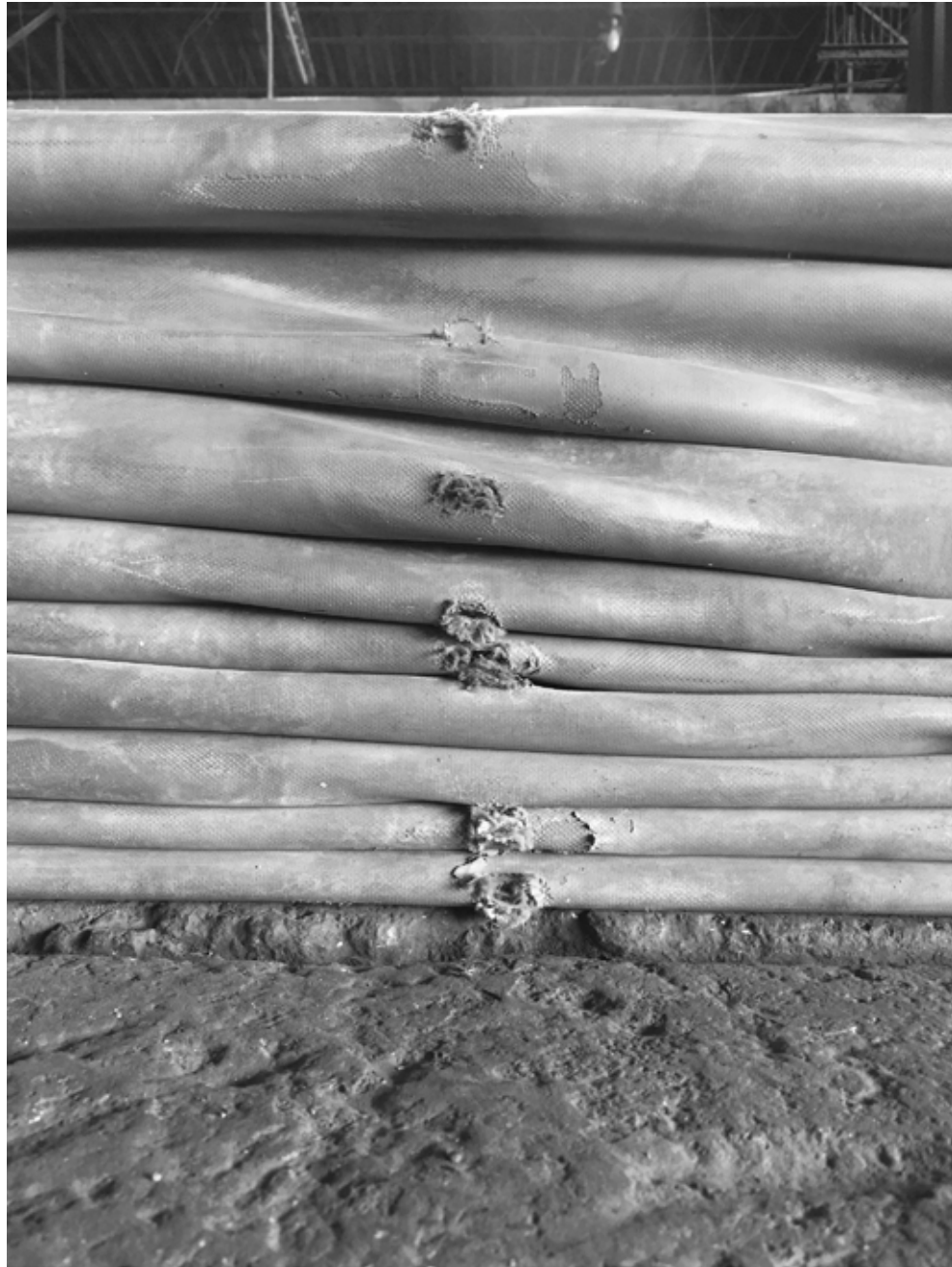
Desgaste presentado en los acoples flexibles, generado por la fricción de los componentes entre sí. Esta fricción es producto de la irregularidad de la vía férrea en el país.
