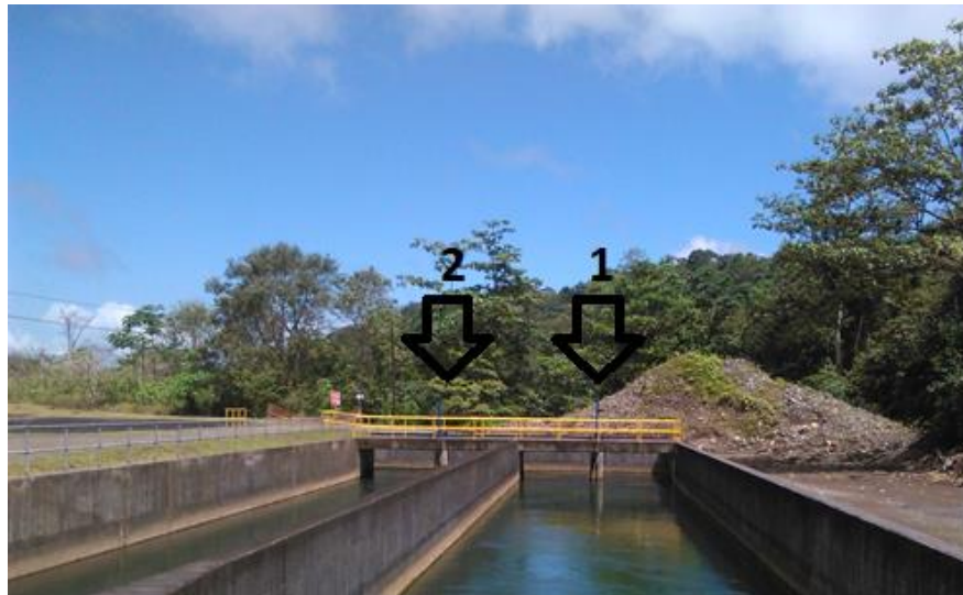
Figura 2.4 Compuertas del desarenador.
