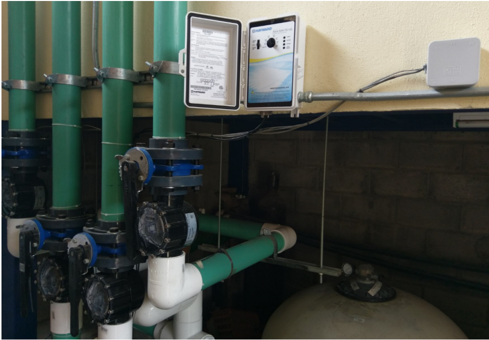
Figura 3.21: Cuarto de maquinas, piscina del TEC.
