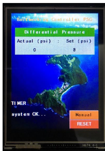
Figura 5.6. Mensaje de disparo de lavado por Timer. Imagen tomada durante una prueba de campo.
