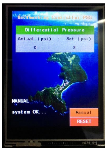
Figura 5.7. Mensaje de disparo de lavado por activación Manual. Imagen tomada durante una prueba de campo.
