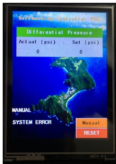
Figura 5.15. Mensaje de disparo de lavado por activación Manual (controlador en modo backup). Imagen tomada durante una prueba de campo.
