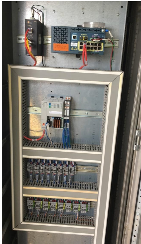
Figura 7. 1 Gabinete de control instalado en la plazoleta 1.
