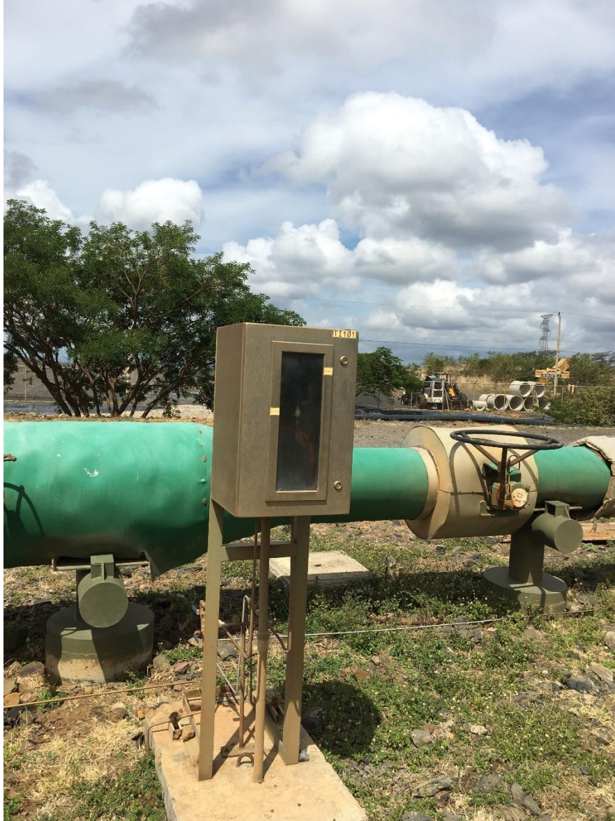
Figura A. 7 Instrumentación instalada en el pozo 1 Pailas.
