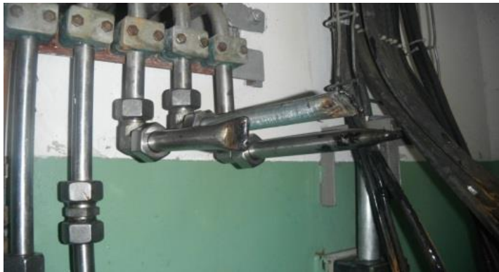
Figura 4. Tuberías de aceite
