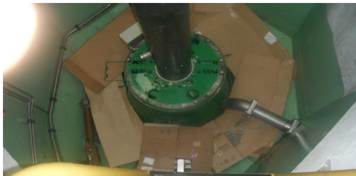
Figura 2. Foso de Turbina
