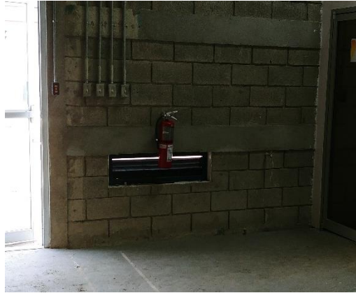
Figura 5.1. Extintor de Bodega Fuente: Elaboración propia
