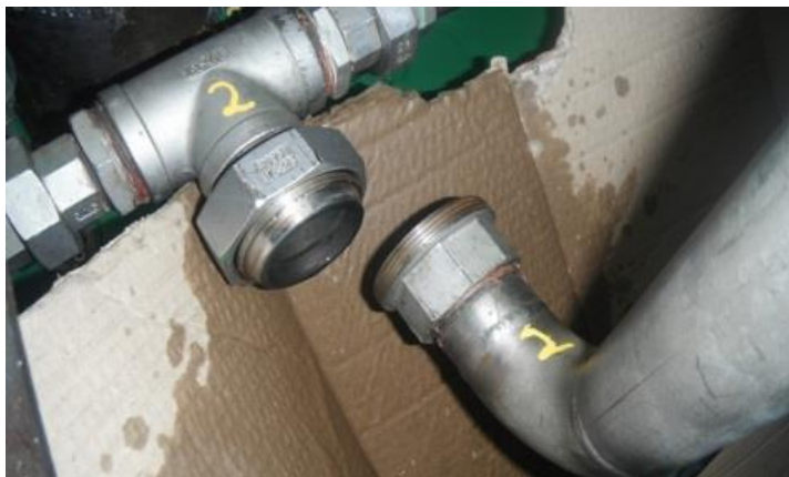
Figura 5. Tuberías de agua
