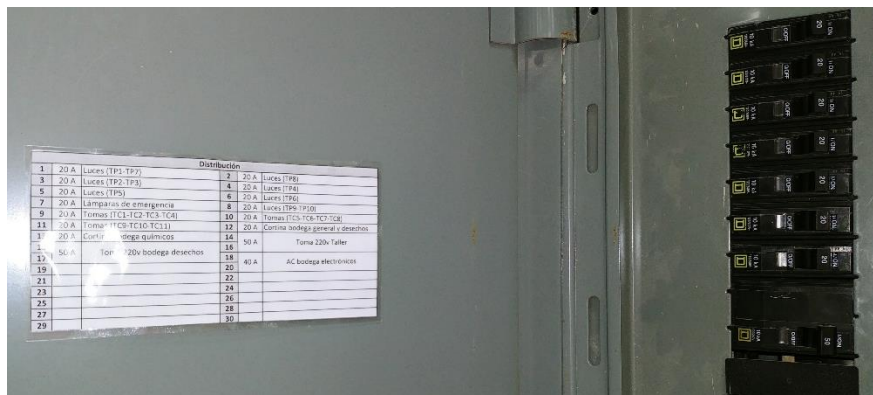
Figura 5.13. Centro de Carga Fuente: Elaboración propia
