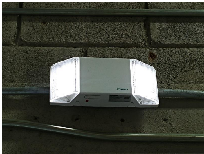
Figura 5.8. Lámpara de Emergencia Fuente: Elaboración propia
