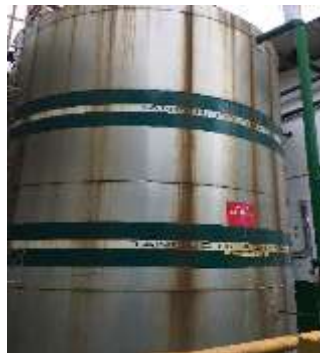
Figura 12. Tanque de agua caliente
