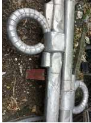
Figura 14. Tubería de trasiego de búnker
