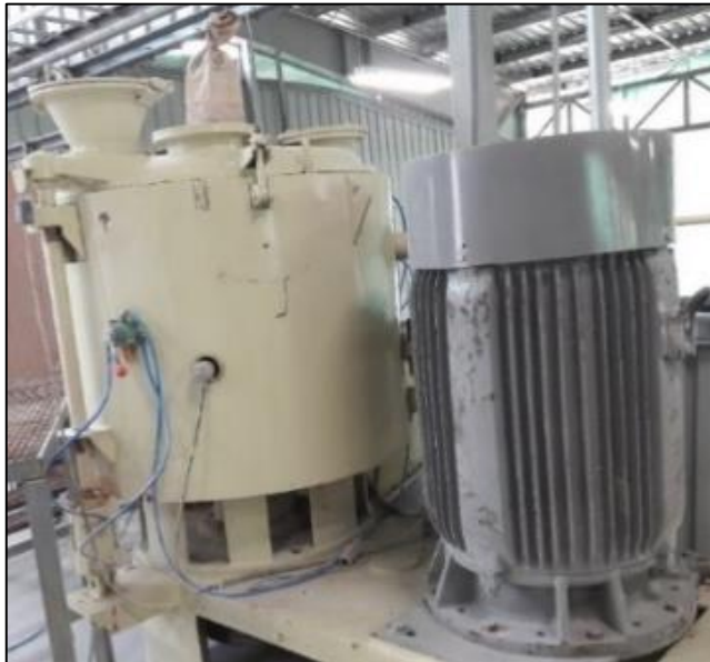
Figura 41. Mezclador de materias primas.
