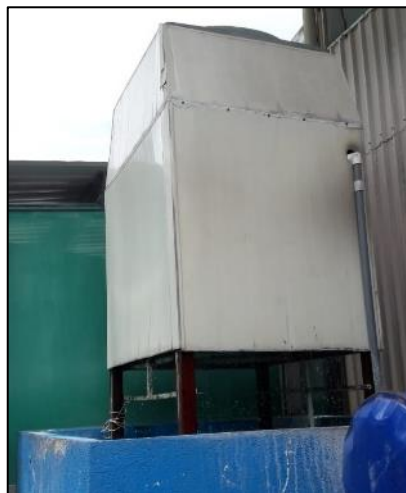
Figura 51. Torre de Enfriamiento para sistema de enfriamiento 1.
