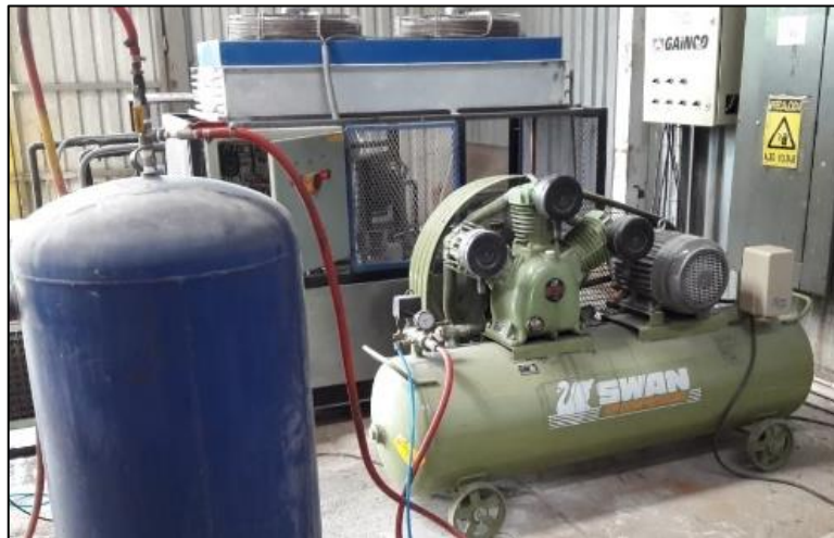
Figura 50. Compresor del sistema de aire comprimido y Evaporador del sistema de enfriamiento.
