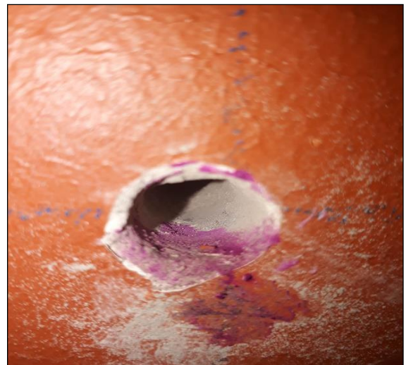
Fotografía 42. Prueba de fenolftaleína muro F
