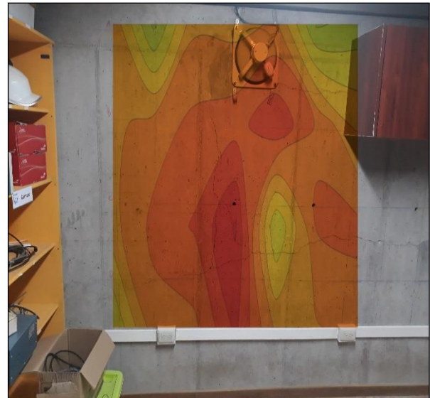
Figura 14. Mapeo muro A sección 1 Fuente: Gimp 2
