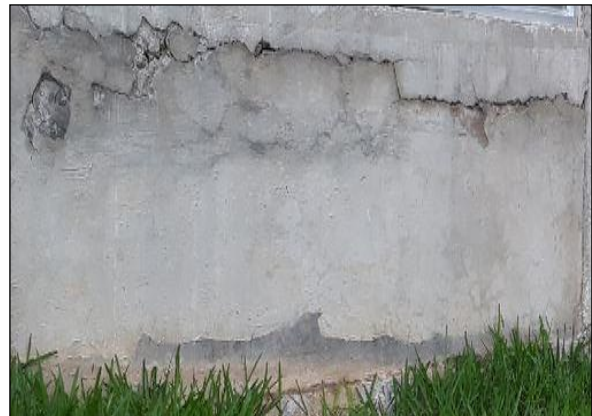
Fotografía 9. Muro contiguo a los elementos en estudio con daño estructural debido a la acción sísmica
