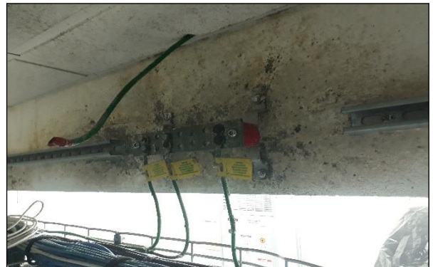
Fotografía 14. Desintegración del concreto de las vigas
