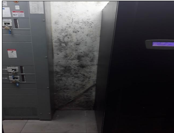
Fotografía 16. Presencia de hongos en los muros
