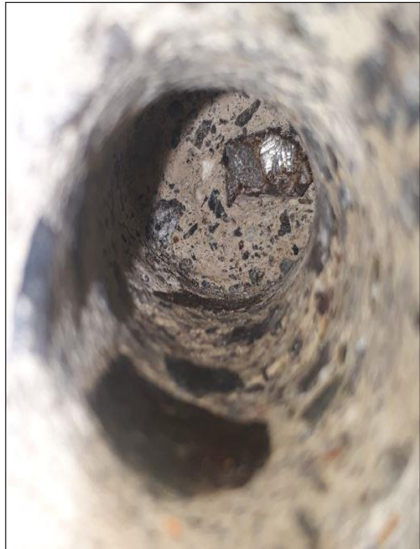
Fotografía 37. Prueba de fenolftaleína muro B
