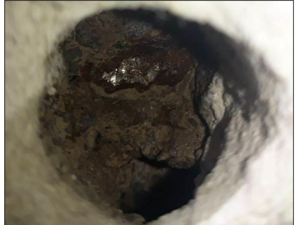
Fotografía 13. Varilla corroída muro D
