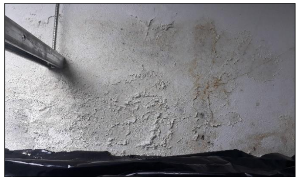
Fotografía 15. Desprendimientos de acabados en las paredes
