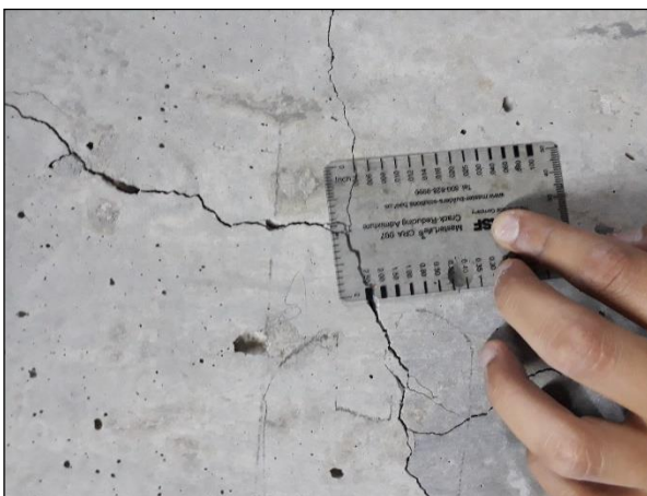
Fotografía 7. Amplias zonas de agrietamiento superando los 5 mm de espesor de grieta
