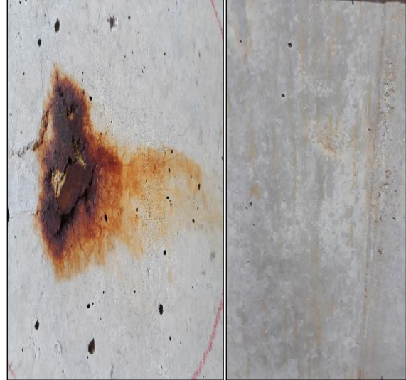
Fotografía 8. Picadura y exfoliación localizada debido a la corrosión, parte externa del muro A
