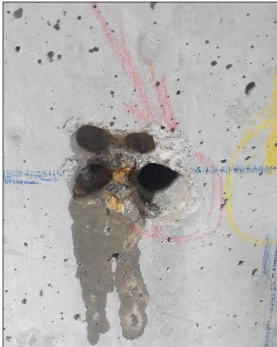
Fotografía 35. Prueba de fenolftaleína muro A sección 1
