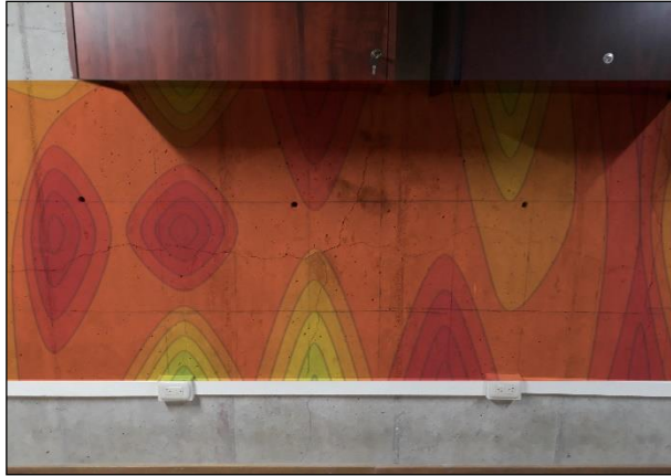
Figura 15. Mapeo muro A sección 2 Fuente: Gimp 2
