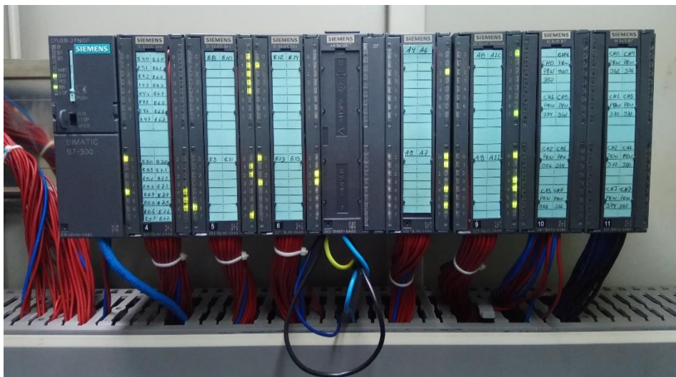
Figura 5.2 PLC de la planta.
