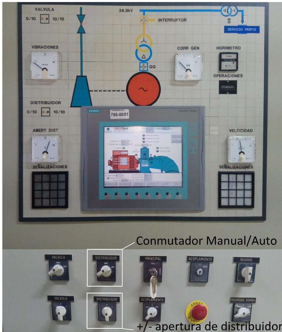
Figura 3.2 Panel de control de la planta.
