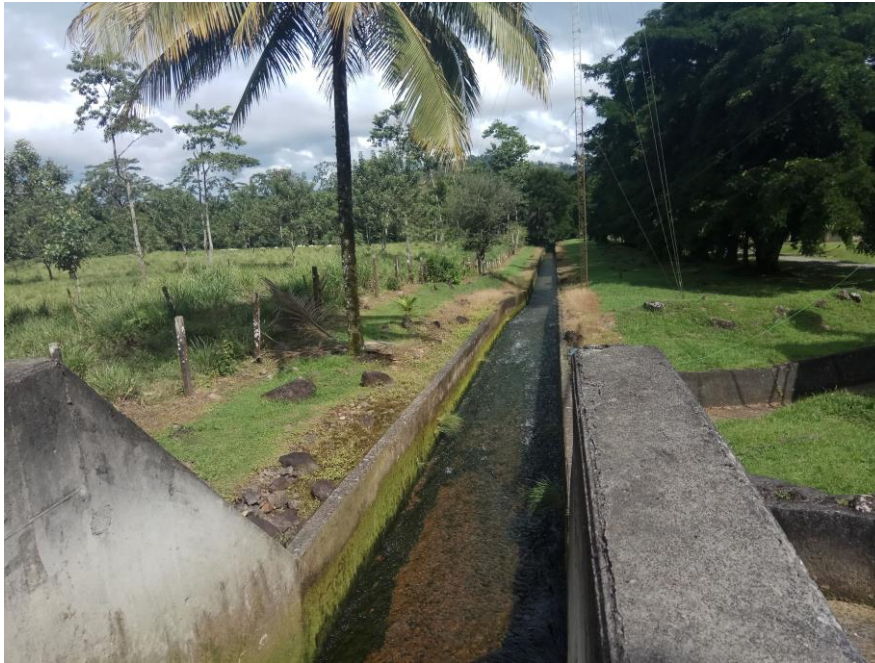
Figura 3.3 Canal de desvío de la antecámara.
