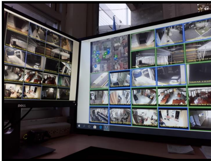
Figura 27: Instalación Seguridad y Vigilancia 2
