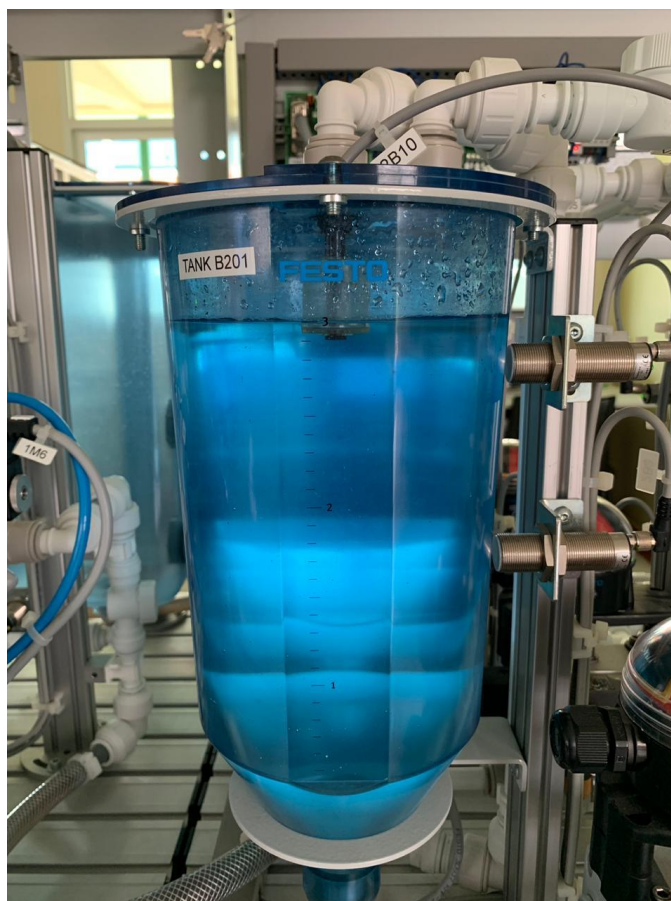
Figura 70. Nivel de agua en el tanque B201 antes de iniciar el programa temporizado 3.
