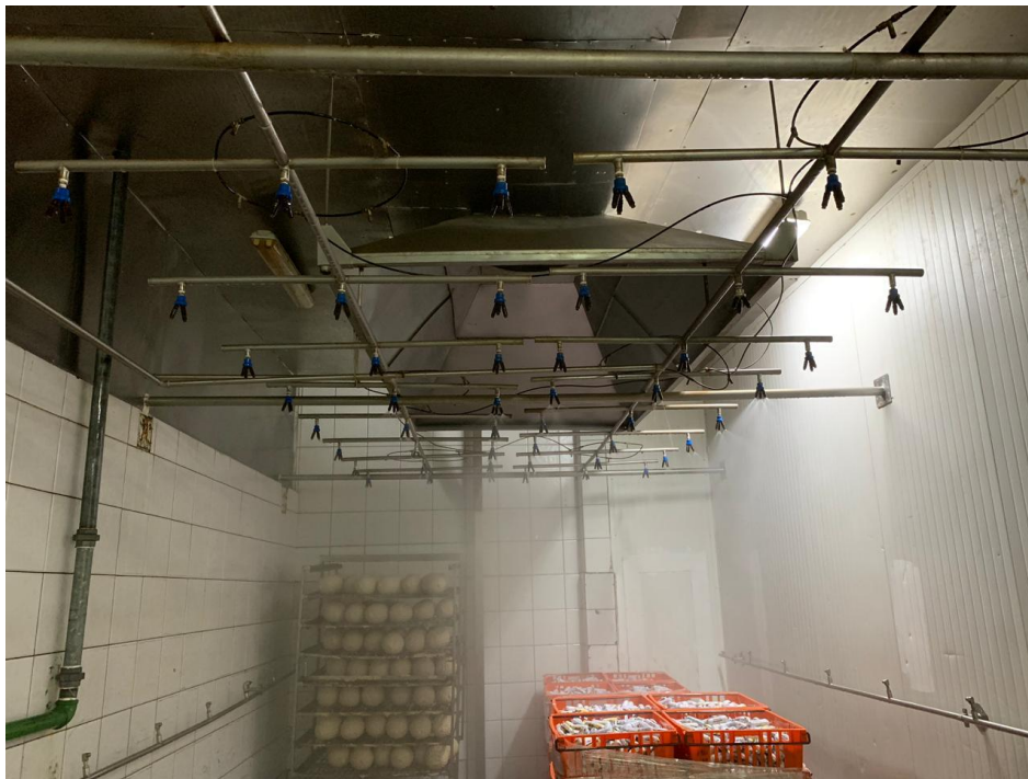
Figura 1. Cuarto de rociado.
