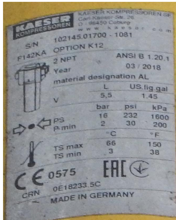
Figura 44. Datos de placa del filtro F142KA ubicado en el cuarto de compresores.
