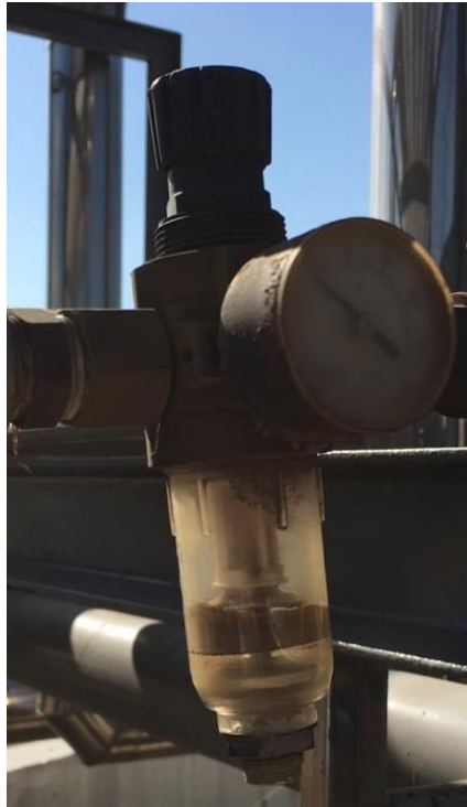
Figura 47. Presencia de óxido y harina de render en filtro ubicado en el techo de la planta.
