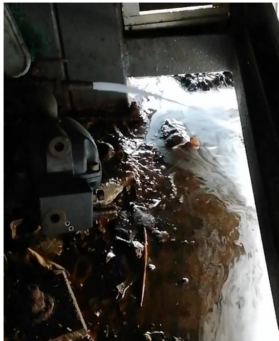
Figura 42. Purga manual del tanque de aire comprimido 1 del cuarto de compresores.
