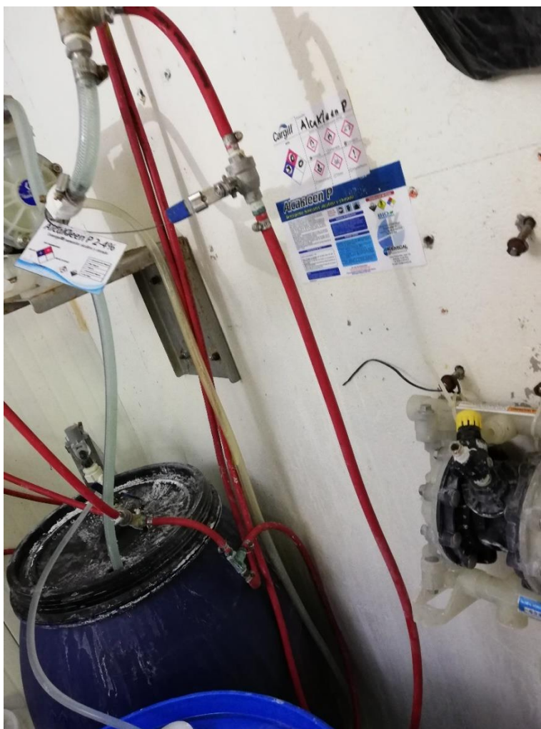
Figura 98. Diseño inadecuado de bajante y conexión a equipos del sistema centralizado de aseo, en bodega de químicos.
