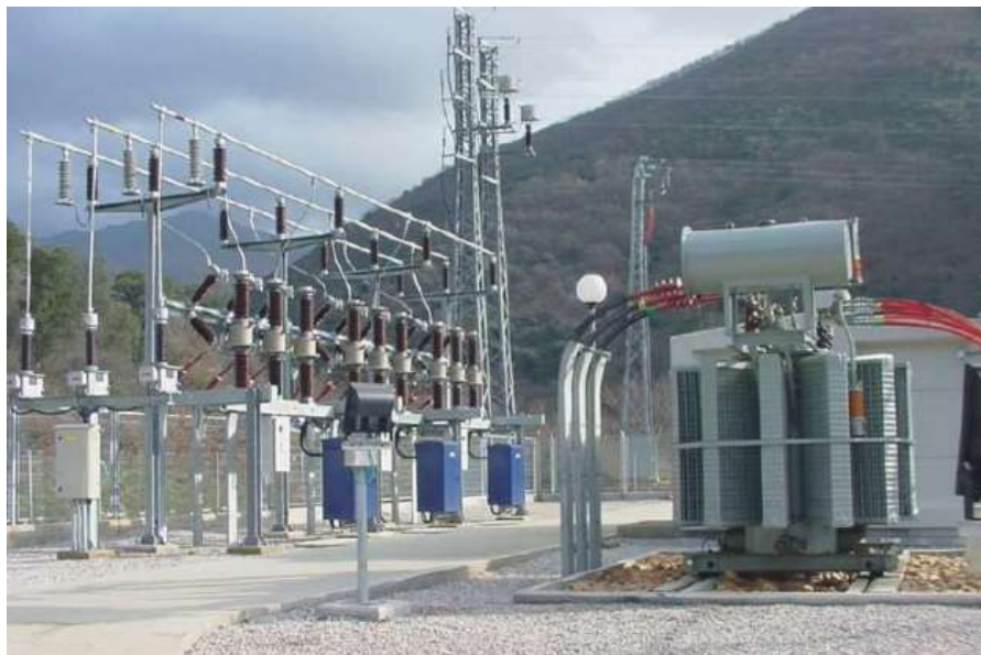
Figura 7. Central de transformación
