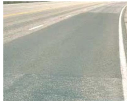
Figura 52. Bache – severidad baja
