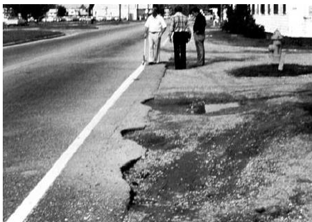
Figura 37. Grieta de borde – severidad alta Fuente: Norma ASTM D6433-18, 2018
