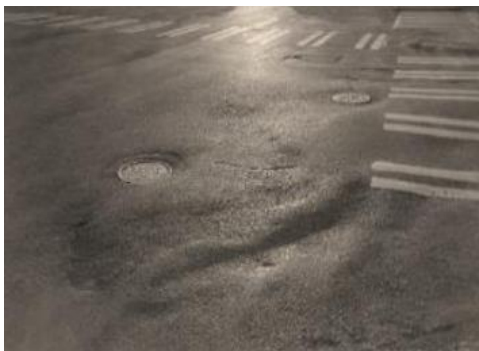
Figura 68. Deformación por desplazamiento – severidad baja
