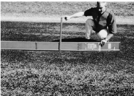
Figura 31. Depresión – severidad baja Fuente: Norma ASTM D6433-18, 2018
