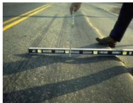
Figura 65. Rodera – severidad media Fuente: Ministerio de Obras Públicas y Transportes, 2011
