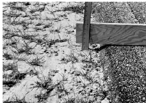
Figura 43. escalonamiento calzada – espaldón severidad baja
