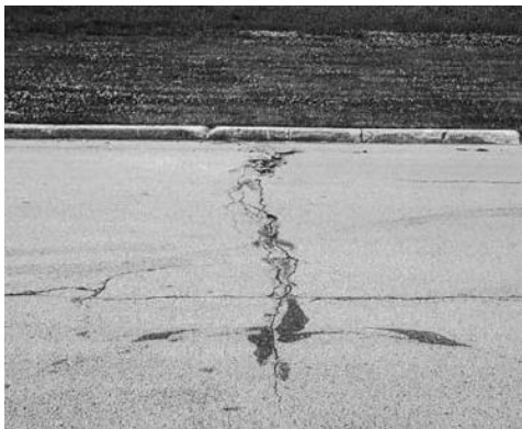
Figura 50. grieta longitudinal – transversal severidad alta
