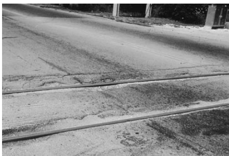
Figura 61. Cruce de línea férrea – severidad media Fuente: Norma ASTM D6433-18, 2018
