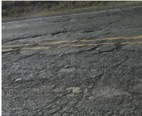
Figura 77. Desgaste superficial – severidad alta
