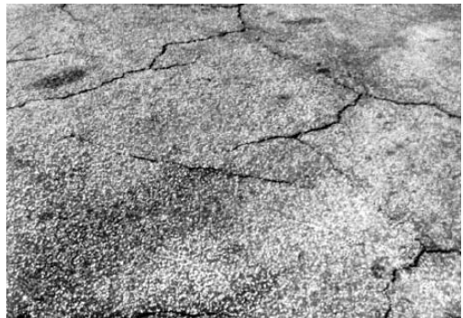
Figura 21. Grietas en bloque – severidad alta Fuente: Norma ASTM D6433-18, 2018
