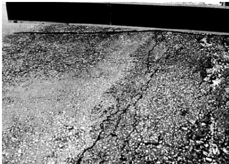
Figura 25. Abultamientos y hundimientos – severidad alta Fuente: Norma ASTM D6433-18, 2018
