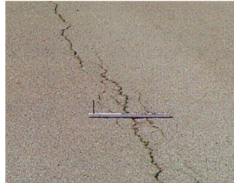
Figura 12. Cuero de lagarto – severidad baja Fuente: Ministerio de Obras Públicas y Transportes, 2011
