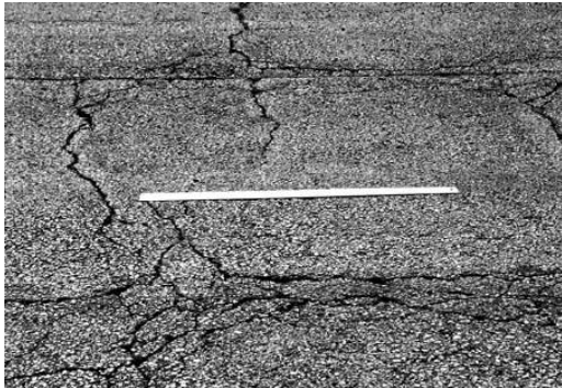
Figura 19. Grietas en bloque – severidad baja Fuente: Norma ASTM D6433-18, 2018
