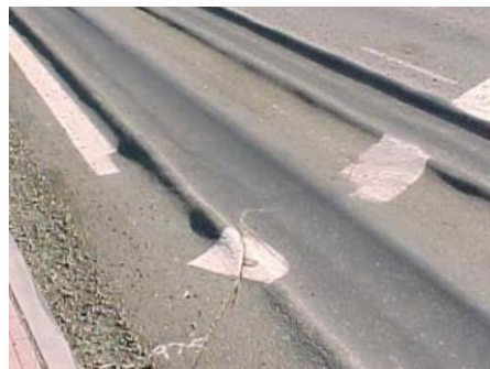
Figura 66. Rodera – severidad alta Fuente: Ministerio de Obras Públicas y Transportes, 2011
