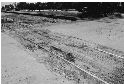
Figura 62. Cruce de línea férrea – severidad alta Fuente: Norma ASTM D6433-18, 2018
