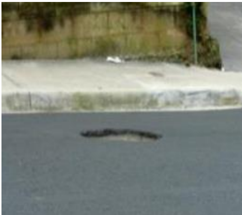
Figura 90. Tapa de registro pluvial hundida Fuente: Ministerio de Obras Públicas y Transportes, 2011
