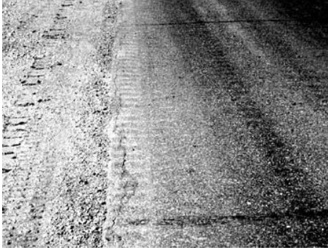
Figura 39. Agrietamiento por reflejo de juntas – severidad baja
