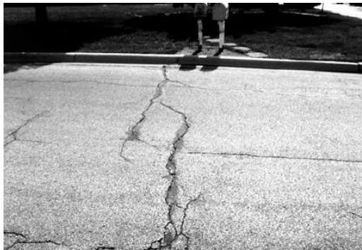
Figura 20. Grietas en bloque – severidad media Fuente: Norma ASTM D6433-18, 2018
