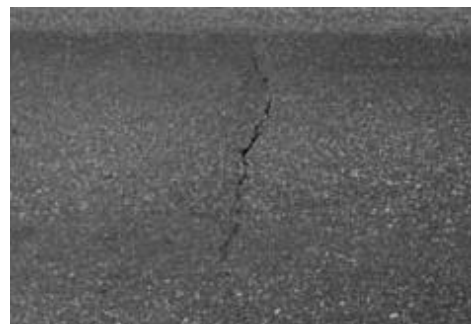
Figura 48. grieta longitudinal – transversal severidad baja Fuente: Norma ASTM D6433-18, 2018
