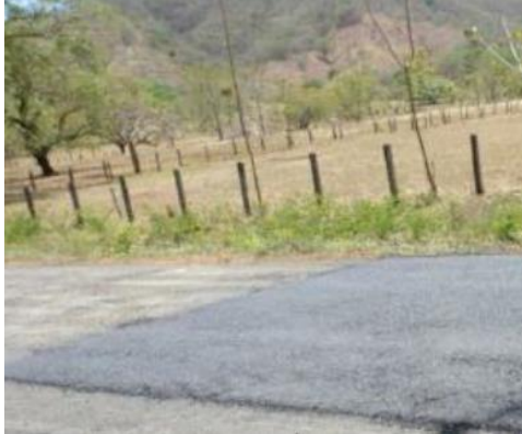
Figura 53. Bache – severidad media Fuente: Ministerio de Obras Públicas y Transportes, 2011
