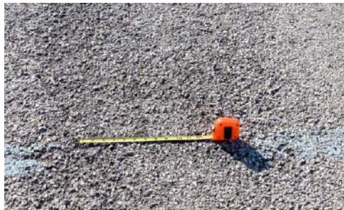
Figura 73. Desprendimiento de agregados – severidad media Fuente: Norma ASTM D6433-18, 2018
