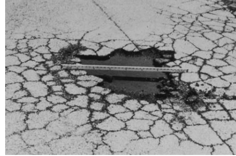
Figura 59. Hueco – severidad alta Fuente: Norma ASTM D6433-18, 2018
