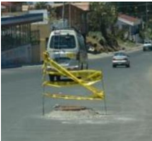
Figura 91. Tapa de registro pluvial levantada Fuente: Ministerio de Obras Públicas y Transportes, 2011
