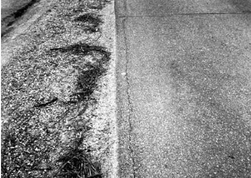
Figura 35. Grieta de borde – severidad baja Fuente: Norma ASTM D6433-18, 2018
