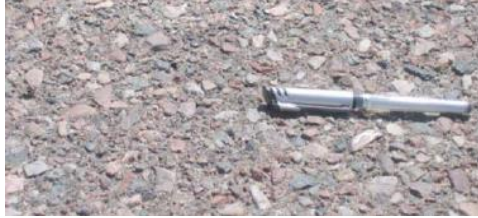
Figura 76. Desgaste superficial – severidad media
