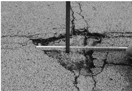
Figura 58. Hueco – severidad media Fuente: Norma ASTM D6433-18, 2018
