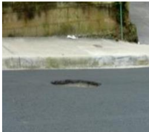
Figura 5. Tapa de registro pluvial hundida
