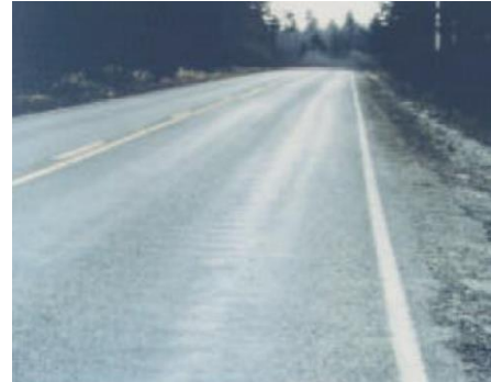
Figura 27. Corrugación – severidad baja Fuente: Ministerio de Obras Públicas y Transportes, 2011
