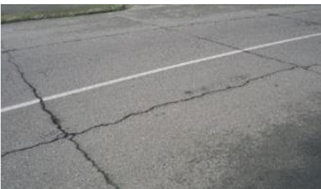
Figura 40. Agrietamiento por reflejo de juntas – severidad media
