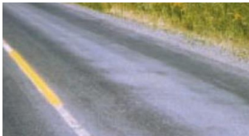
Figura 16. Exudación – severidad media Fuente: Ministerio de Obras Públicas y Transportes, 2011
