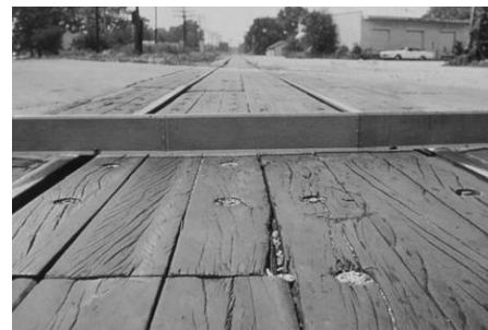
Figura 60. Cruce de línea férrea – severidad baja Fuente: Norma ASTM D6433-18, 2018
