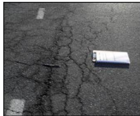
Figura 13. Cuero de lagarto – severidad media Fuente: Ministerio de Obras Públicas y Transportes, 2011
