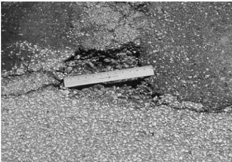
Figura 57. Hueco – severidad baja Fuente: Norma ASTM D6433-18, 2018
