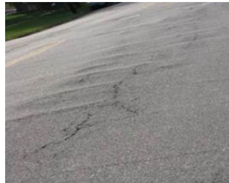
Figura 28. Corrugación – severidad media Fuente: Ministerio de Obras Públicas y Transportes, 2011
