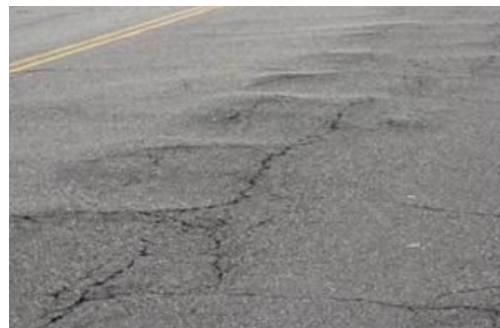
Figura 29. Corrugación – severidad alta Fuente: Ministerio de Obras Públicas y Transportes, 2011
