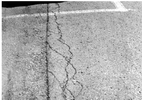
Figura 36. Grieta de borde – severidad media Fuente: Norma ASTM D6433-18, 2018
