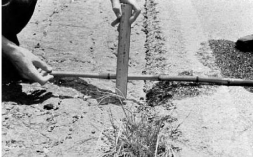
Figura 44. escalonamiento calzada – espaldón severidad media Fuente: Norma ASTM D6433-18, 2018
