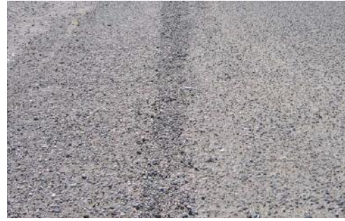
Figura 74. Desprendimiento de agregados – severidad alta
