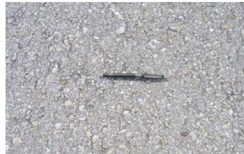
Figura 75. Desgaste superficial – severidad baja Fuente: Norma ASTM D6433-18, 2018
