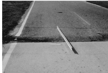
Figura 70. Deformación por desplazamiento – severidad alta
