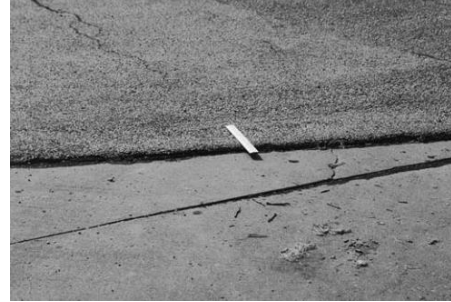
Figura 69. Deformación por desplazamiento – severidad media
