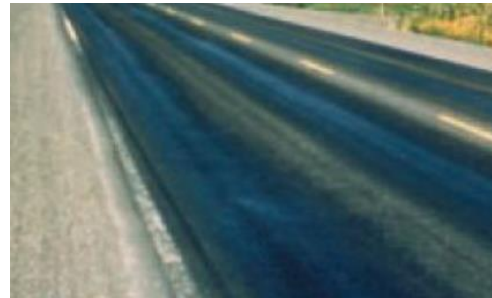
Figura 17. Exudación – severidad alta Fuente: Ministerio de Obras Públicas y Transportes, 2011
