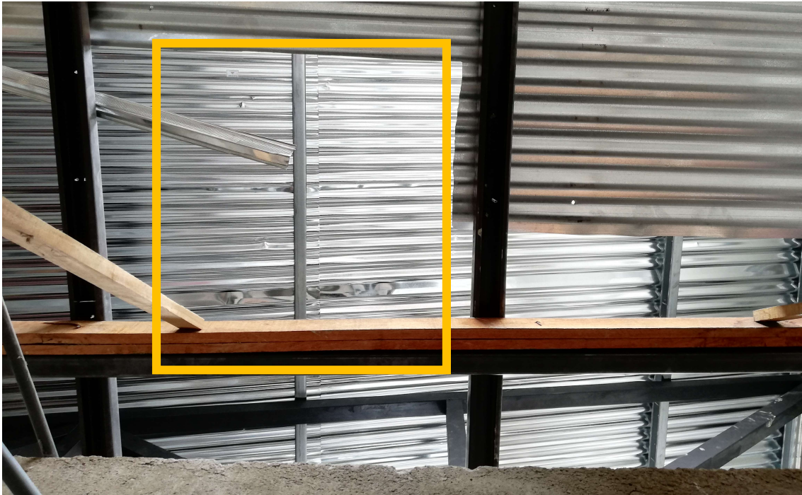
Figura 5. Estructura de techo y cubierta con ondulaciones y deformaciones no aceptables. Fuente. Fotografía propia, 2019.
