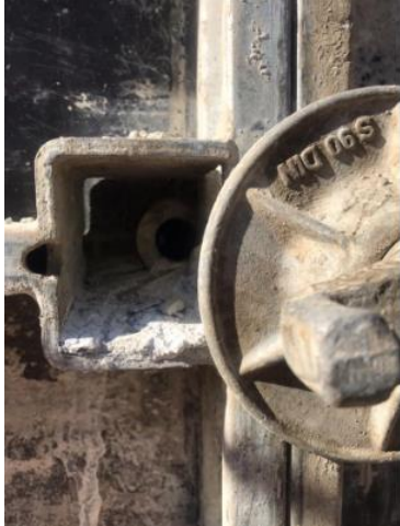
Imagen 12. Falta de accesorios de formaleta Fuente. Elaboración propia
