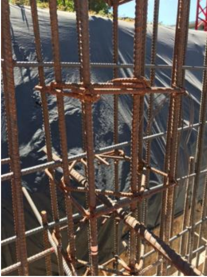
Imagen 15. Cuantía de acero en muro
