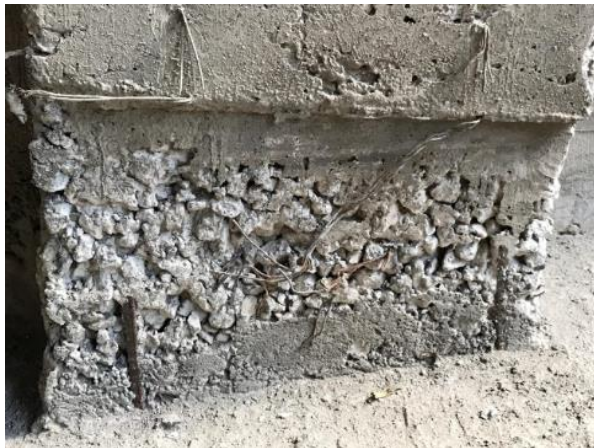
Imagen 2. Columna nivel 0-6.52 con segregación de material grueso
