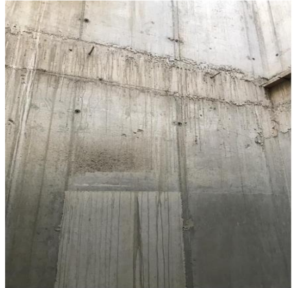
Imagen 3. Muro ducto de elevadores nivel 0-6.52 sin limpieza
