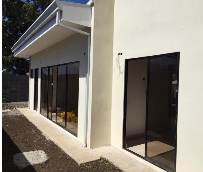
Canoas y bajantes galvanizados
