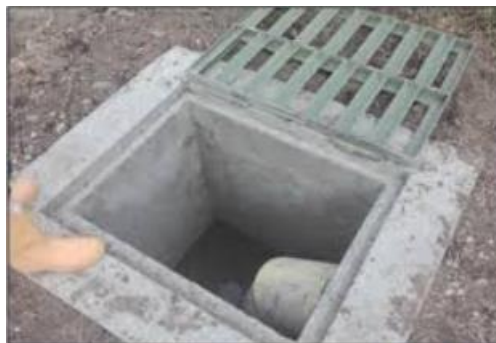
Caja de registro pluvial
