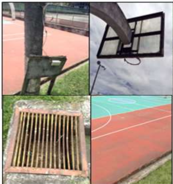
Figura 19. Daños encontrados en la Cancha multiuso.
