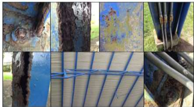
Figura 23. Daños encontrados en la Cancha Sintética.
