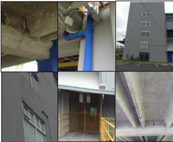
Figura 11. Daños encontrados en el gimnasio principal.
