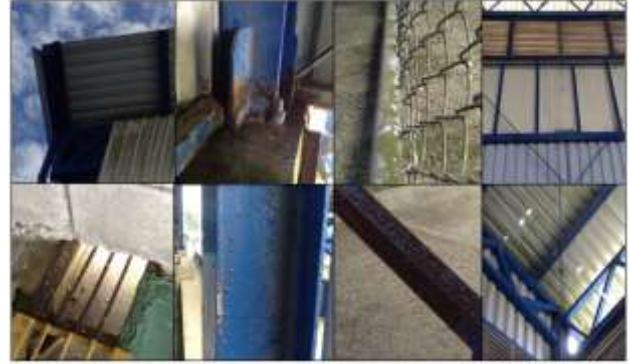
Figura 13. Daños encontrados en la Cancha de Tenis#1.
