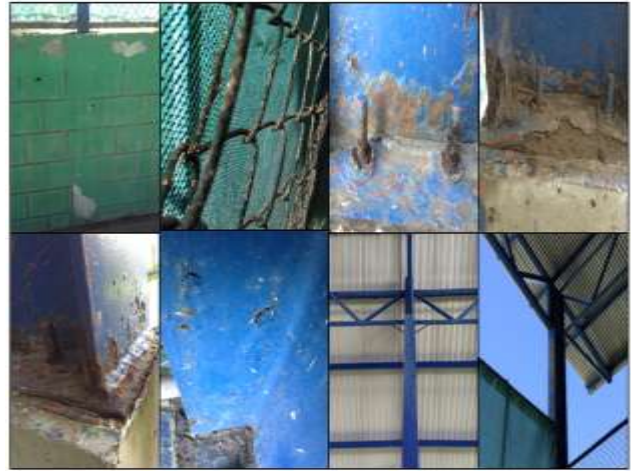
Figura 15. Daños encontrados en la Cancha de Tenis#2.
