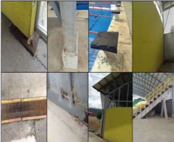
Figura 25. Daños encontrados en la Piscina Olímpica.
