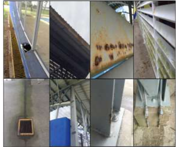
Figura 27. Daños encontrados en la Piscina Pedagógica.
