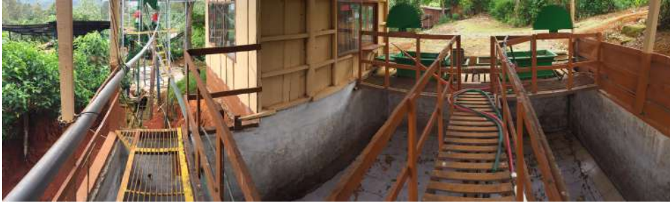
Anexo 4. Ejemplo tanque de almacenamiento y canalización de aguas, Proyecto Micro Beneficio
