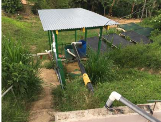
Anexo 7. Ejemplo canalización de aguas, Proyecto Micro Beneficio Fuente: Elaboración propia
