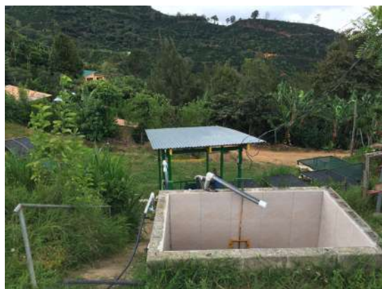
Anexo 6. Ejemplo tanque de almacenamiento, Proyecto Micro Beneficio
