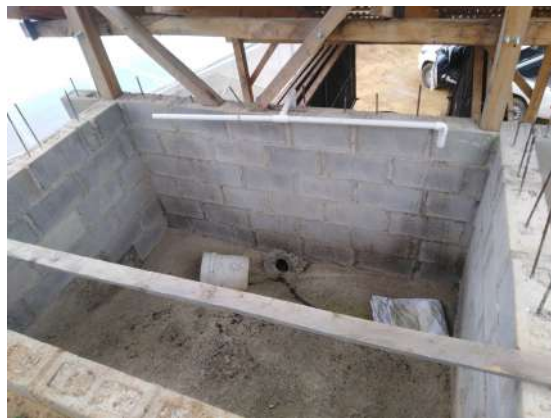
Anexo 5. Ejemplo tanque de almacenamiento de la fruta del café, Proyecto Micro Beneficio
