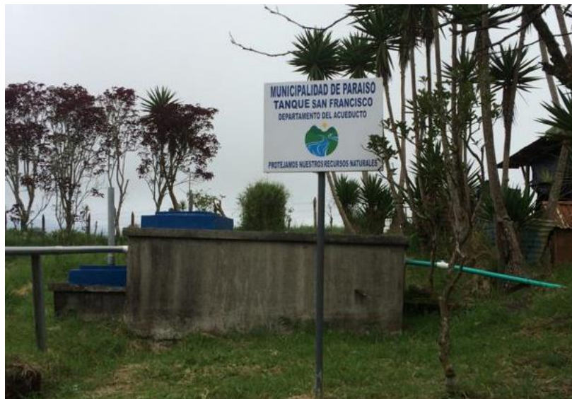
Figura 8. Tanque San Francisco con capacidad de 30000 L.
