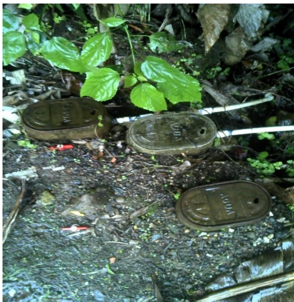
Figura 6. Tres medidores pertenecientes a la red de distribución de la comunidad de San Francisco de Birrisito.
