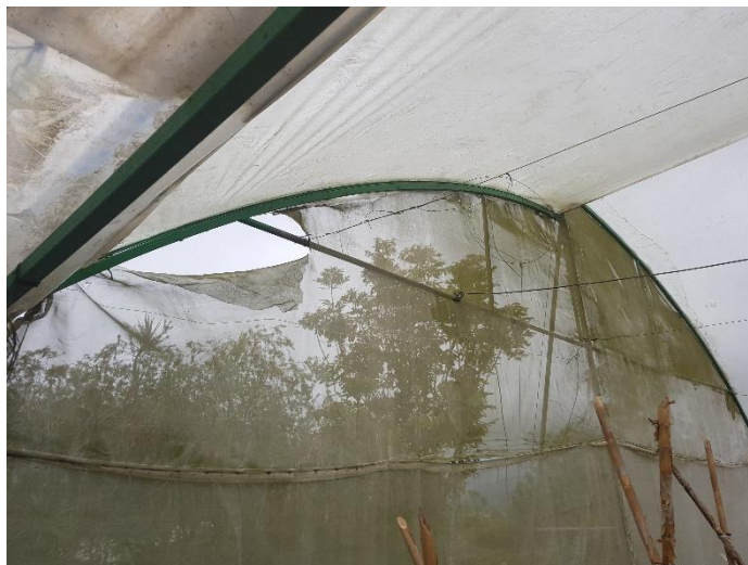
Figura 64. Primera anomalía del invernadero de la Escuela de Ingeniería Agrícola, Cartago
