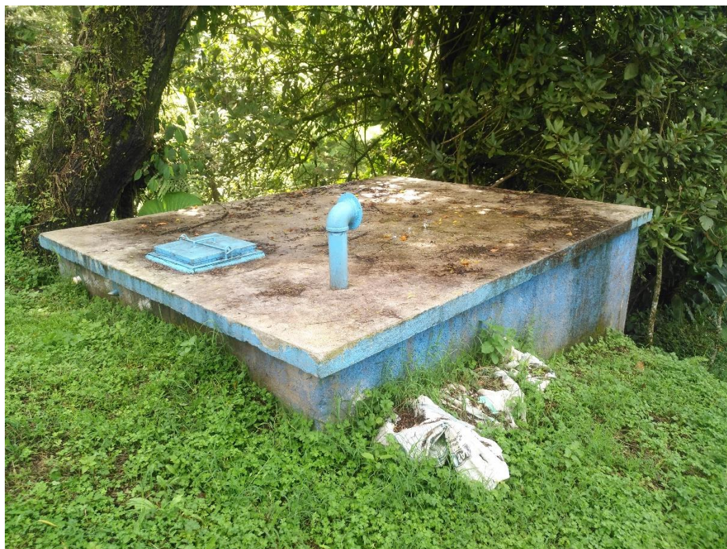
Figura 13. Tanque de almacenamiento
