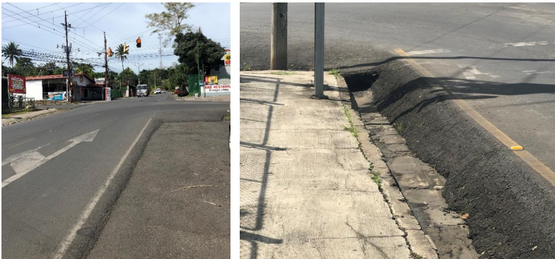
Figura N° 4-31 – Desnivel entre la calzada y la berma.
