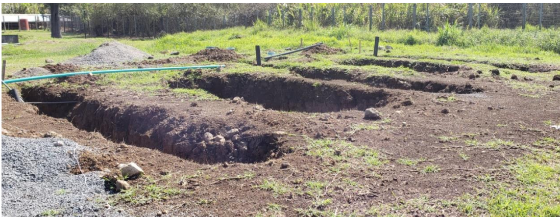
Figura 4.06. Excavaciones realizadas para la construcción del campo de drenaje y sus componentes.
