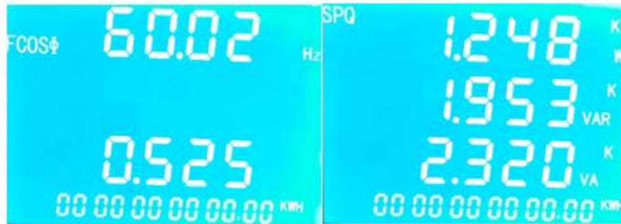
Imagen 18. Foto en campo de pantalla del medidor de energía multifuncional trifásico YIGEDIANQI. Fuente: Propia
