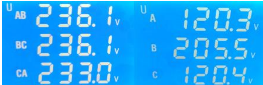
Imagen 17. Foto en campo de pantalla del medidor de energía multifuncional trifásico YIGEDIANQI. Fuente: Propia
