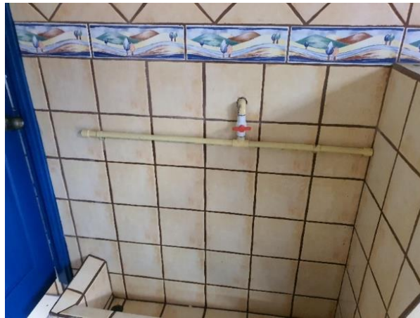
Figura 36. Baño del gimnasio de la escuela Domingo Faustino Fuente: Tomada por el investigador
