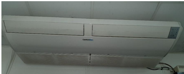
Figura 21. Aire Acondicionado del laboratorio de robótica, escuela de Loyola Fuente: Tomada por el investigador
