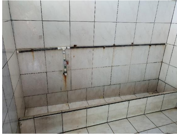
Figura 35. Baño de la escuela Domingo Faustino Fuente: Tomada por el investigador
