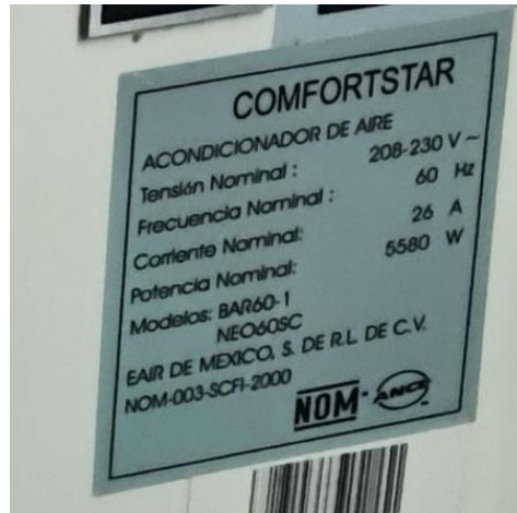
Figura 39. Datos de placa del aire acondicionado del laboratorio de cómputo Fuente: Tomada por el investigador
