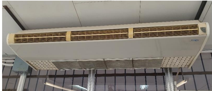
Figura 20. Aire Acondicionado del laboratorio de cómputo, escuela de Loyola Fuente: Tomada por el investigador
