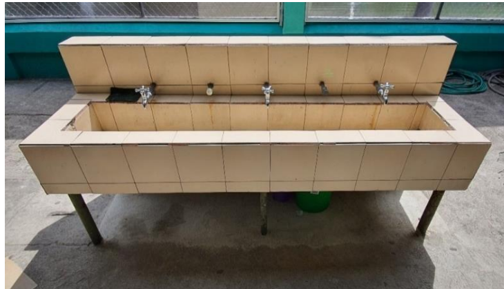
Figura 40. Batería para lavado de manos #1 en escuela Domingo Faustino Fuente: Tomada por el investigador
