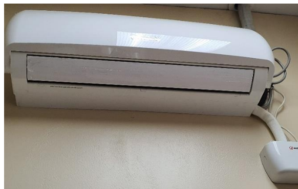
Figura 28. Aire acondicionado del PIAD en escuela de Loyola Fuente: Tomada por el investigador
