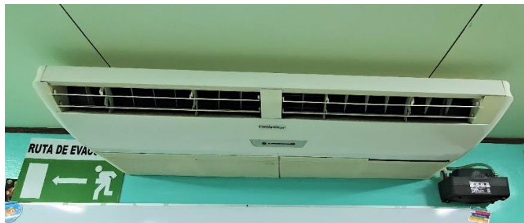
Figura 38. Aire acondicionado del laboratorio de cómputo de la escuela Domingo Faustino Fuente: Tomada por el investigador
