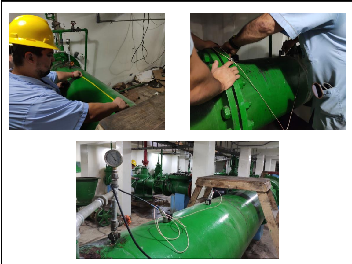
Figura 25. Proceso de Ubicación de Transductores para la medición de variables en la estación de Rebombeo Uruca.
