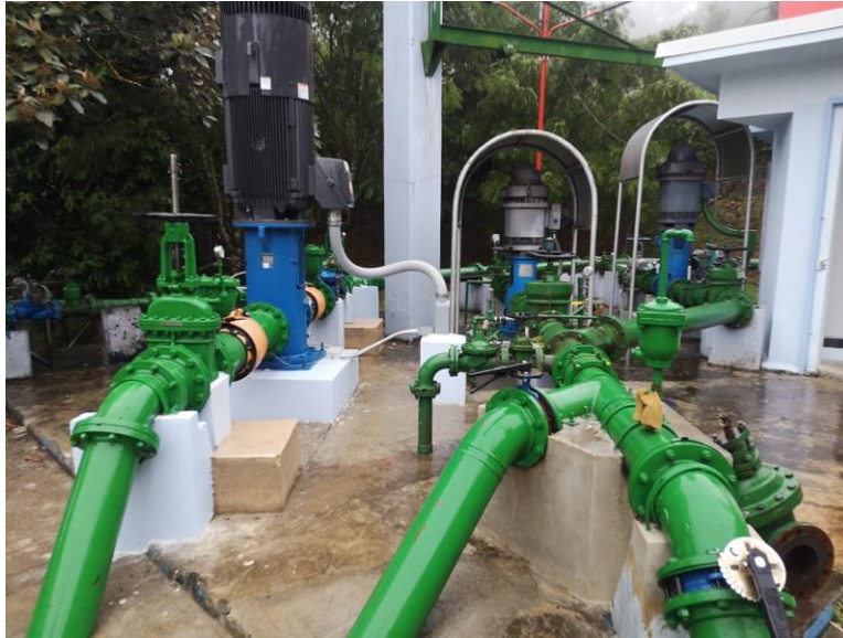
Figura 3. Estación de Bombeo con Sistema Tipo Booster con equipo Sumergible (Estación de Bombeo San Antonio, Área 5).
