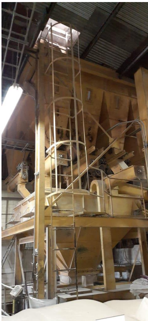
Figura 33. Tolvas de dosificación Fuente: Elaboración propia.
