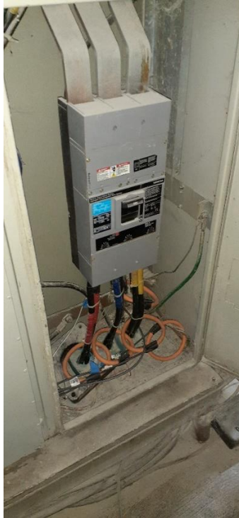
Figura 37. CT's instalados para medición de corriente del equipo eGauge 4115
