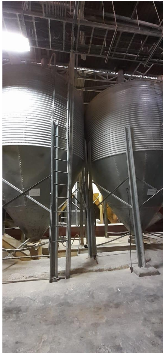
Figura 29. Silos para almacenamiento de harina de soya Fuente: Elaboración propia.
