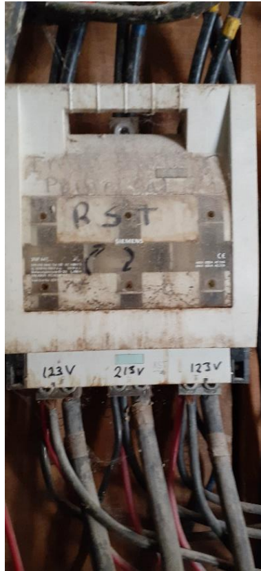
Figura 43. Interruptor con fusibles 630A NP447 Fuente: Elaboración propia.
