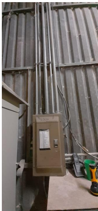
Figura 22. Tablero eléctrico en la planta de alimentos Fuente: Elaboración propia
