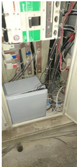
Figura 36. Instalación equipo de medición eGauge 4115 en la planta Fuente: Elaboración propia.
