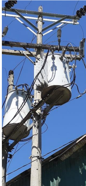
Figura 19. Transformadores existentes conexión delta abierta Fuente: Elaboración propia.
