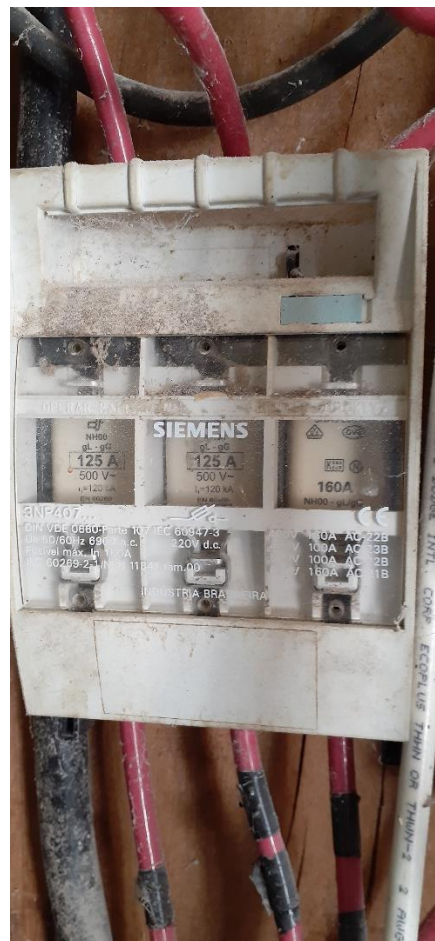
Figura 45. Combinación de fusibles en los interruptores Fuente: Elaboración propia.
