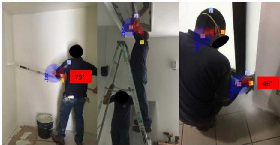
Figura IV. 5. Ejemplos de posturas inadecuadas en tareas de mantenimiento vario
