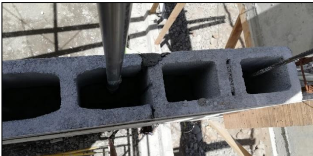
Figura 46. Problemas en colocación de bloques de mampostería.
