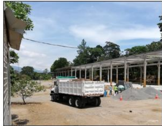
Figura 47. Inadecuado control de polvo
