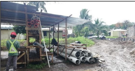
Figura 20. Taller de armadura y centro de acopio de acero y tubería PVC de material nuevo
