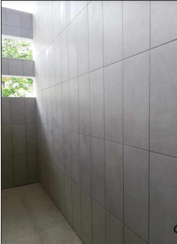
Figura 70. Resultado de la colocación de la cerámica en las paredes de baños.
