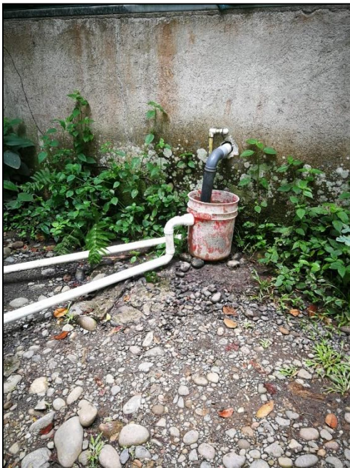
Figura 83. Tratamiento de aguas del comedor del proyecto.
