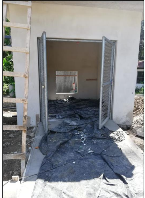
Figura 77. Nivel de piso de bodega relleno. Fuente: Elaboración propia en visita a proyecto en Siquirres.
