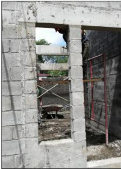
Figura 25. Tipo de columnetas que incrementan residuos
