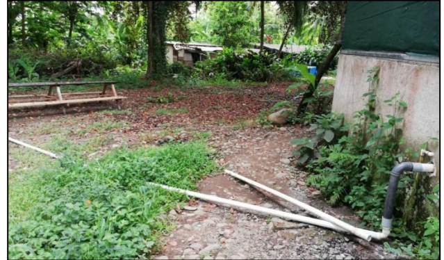
Figura 80. Tuberías del comedor dirigidas sin ninguna filtración y depositadas en el suelo. Fuente: Elaboración propia en visita a proyecto en Siquirres
