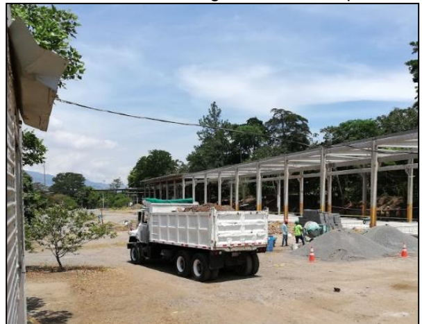
Figura 101. Incorrecto transporte de material en vagoneta.
