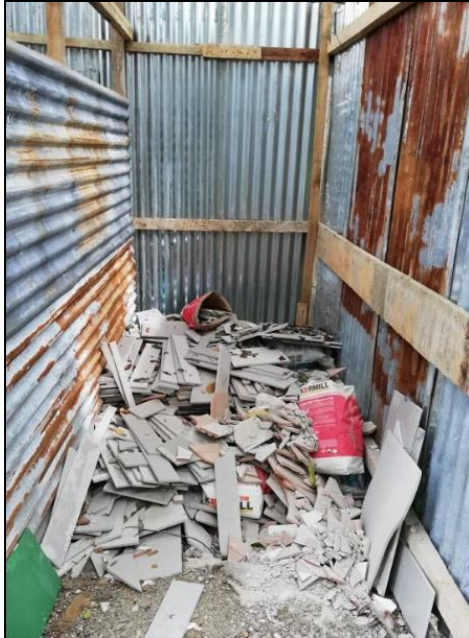
Figura 120. Centro de acopio de residuos de cerámica y porcelanato en la última fecha de control. Elaboración propia en visita a proyecto en Siquirres
