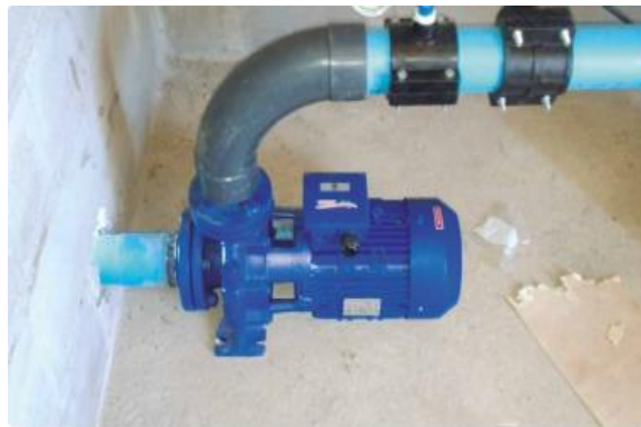
Figura 2.2 Bomba centrífuga de riego.
