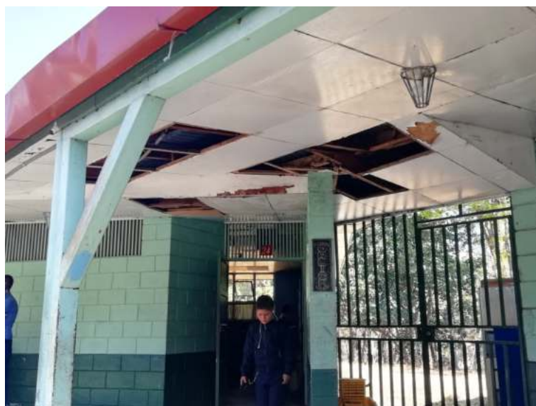
Imagen n°68: Daños en los cielos de los pasillos
