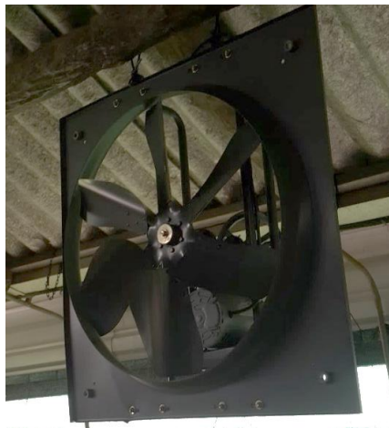
Figura 3.1 Ventilador de 1 hp marca Weg. Foto propia.
