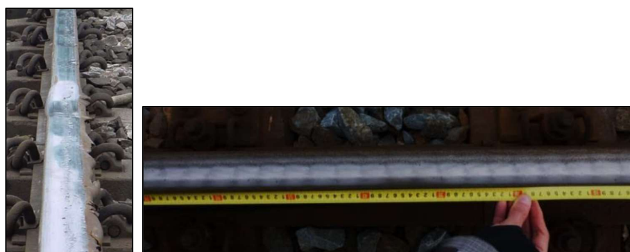
Figura 15. Corrugaciones. Fuente: Oostermeijer (2008); NeTIRail-INFRA (2016)
