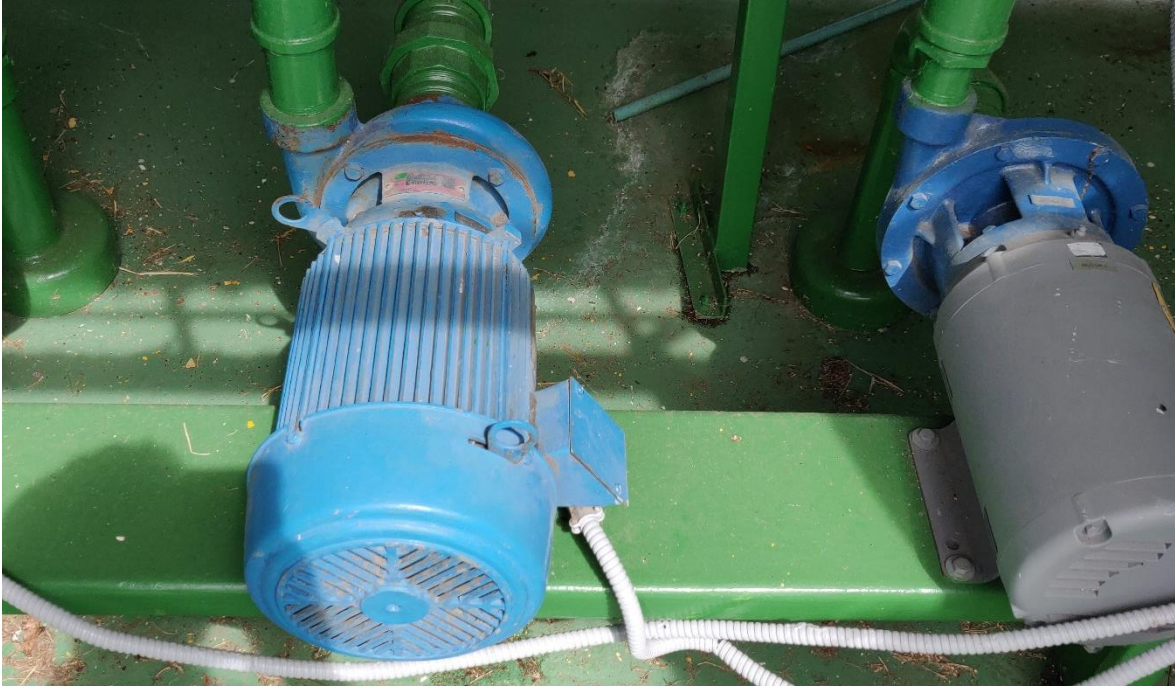
Figura 6.3 Bombas centrífugas y motores instalados. Fuente: Elaboración propia.
