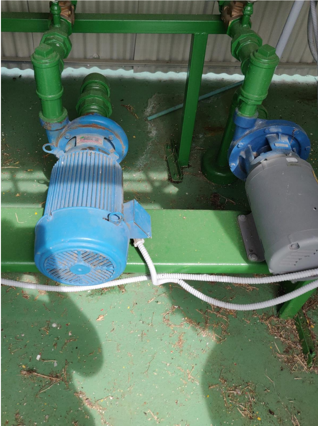
Figura 10.5 Bombas instaladas (se muestran 2 de 3).
