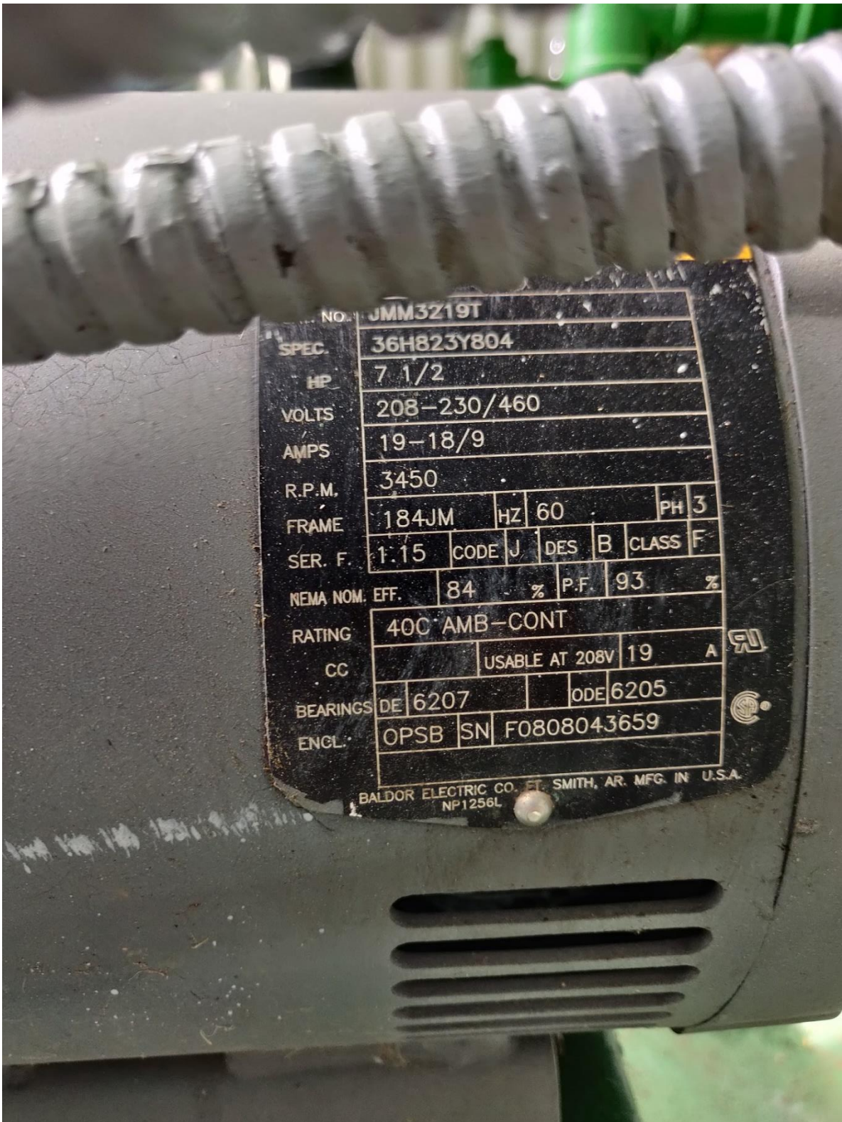
Figura 10.2 Datos de placa del motor Baldor.
