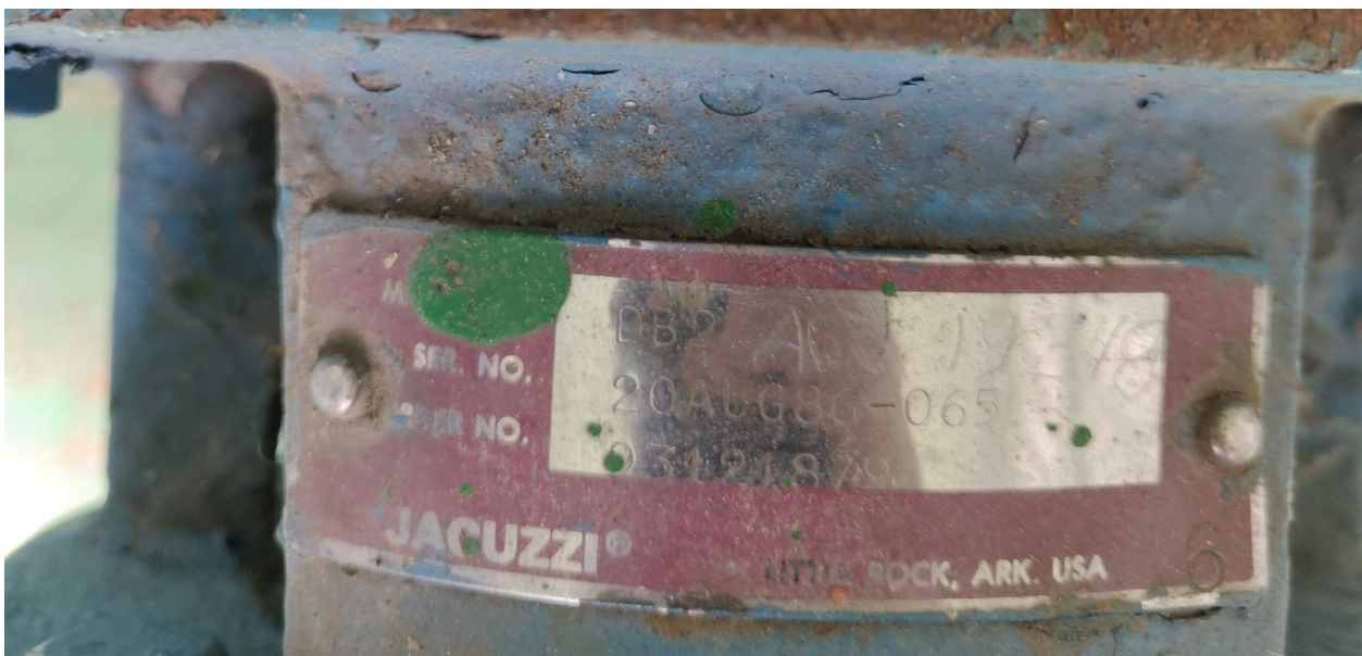
Figura 6.2. Bombas centrífugas instaladas. Fuente: Elaboración propia.
