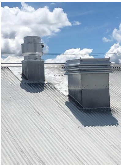
Figura 29. Sistema de inyección-extracción de aire
