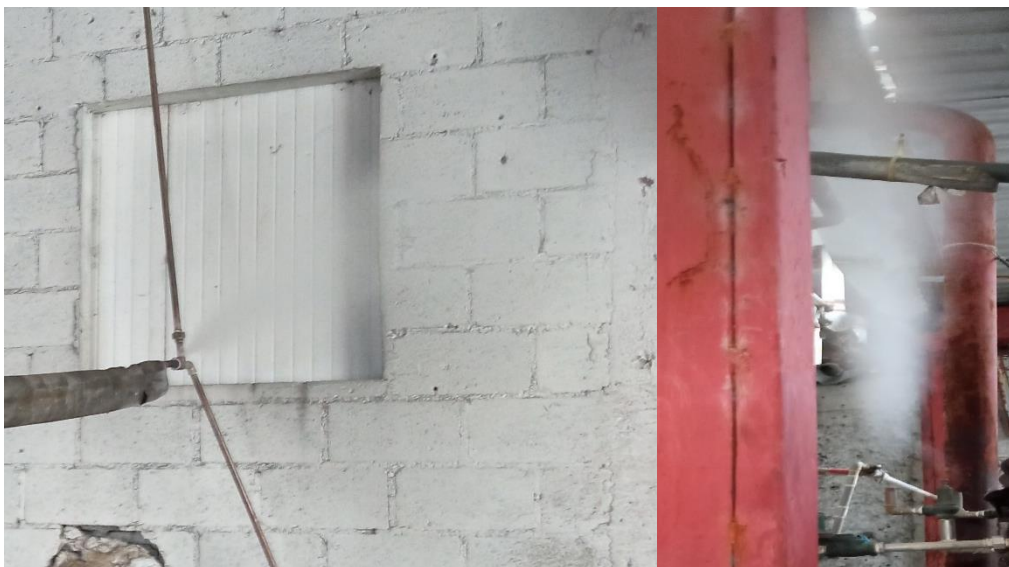
Figura 36. Ejemplo fugas de vapor
