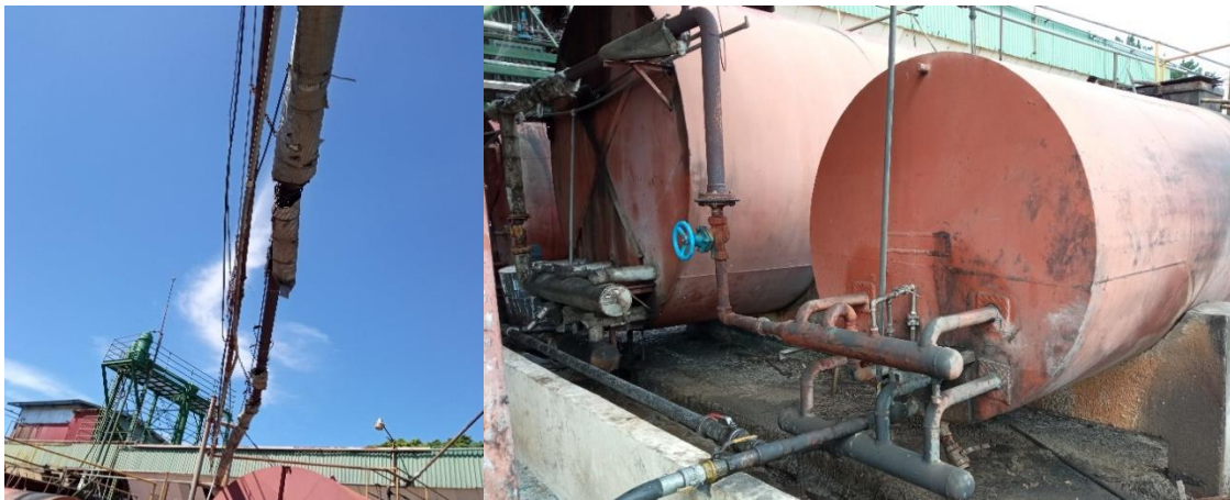
Figura 33. Ejemplo de ausencia y mal estado de aislamiento en tuberías de vapor Fuente: Elaboración propia.
