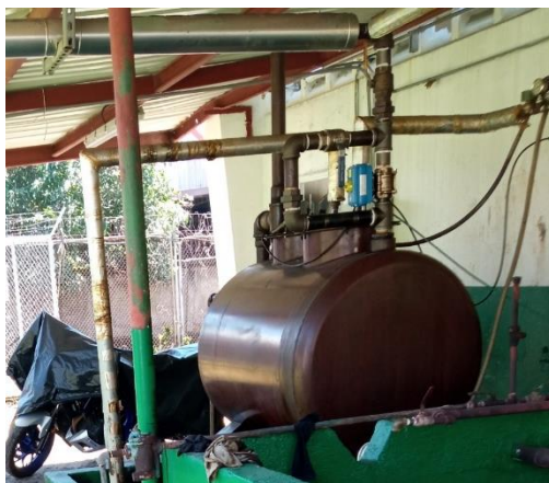
Figura 24. Tanque de búnker diario Fuente: Elaboración propia.
