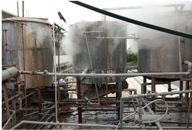
Figura 27. Tanques agua caliente Fuente: Elaboración propia.
