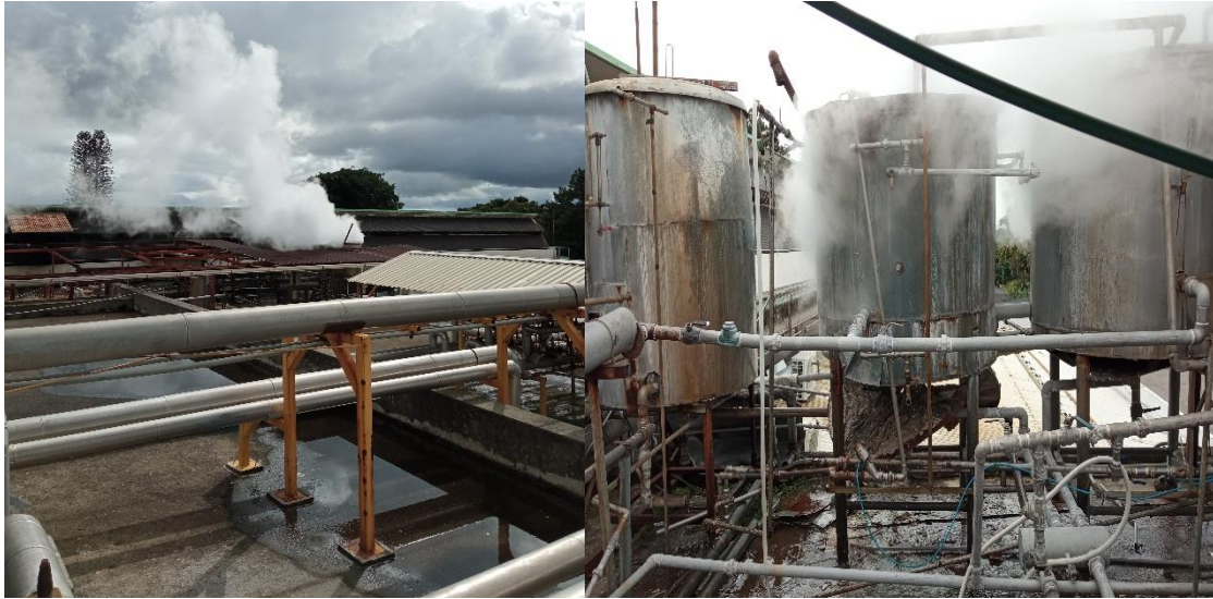
Figura 39. Mal aprovechamiento de vapor en tanques de agua Fuente: Elaboración propia.
