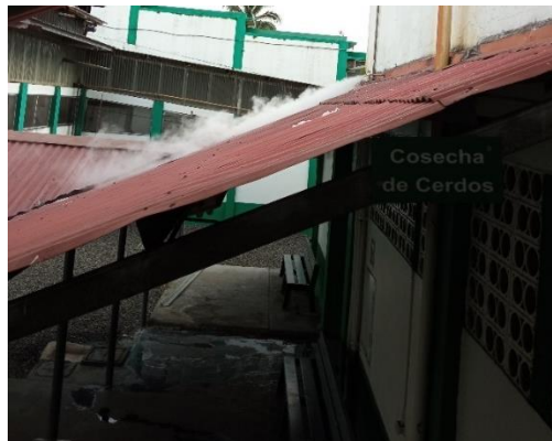
Figura 38. Fuga de vapor en lavandería Fuente: Elaboración propia.
