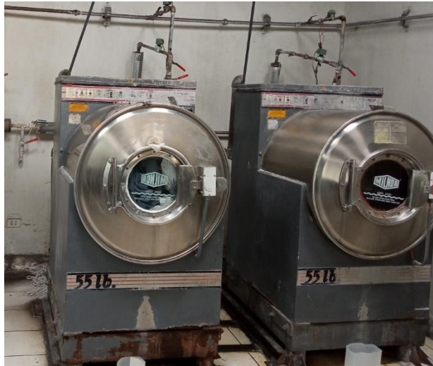
Figura 25. Lavadoras de ropa con suministro de vapor Fuente: Elaboración propia.
