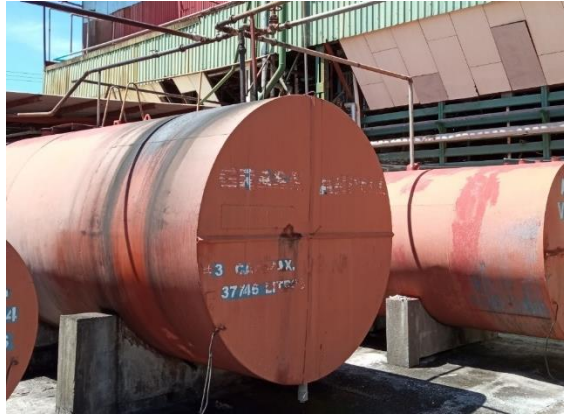
Figura 20. Tanques de almacenamiento, jabonería Fuente: Elaboración propia.
