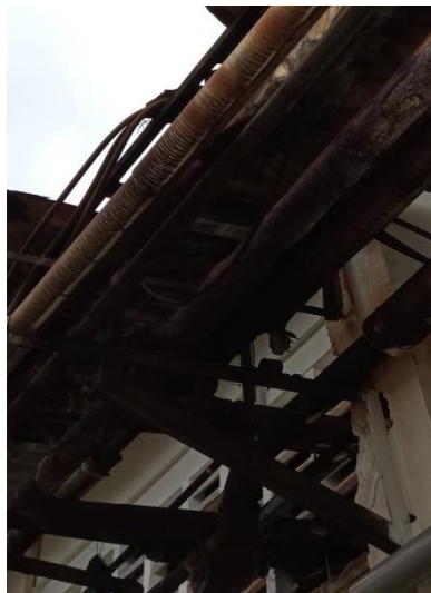
Figura 34. Ejemplo de corrosión en tuberías de vapor Fuente: Elaboración propia.
