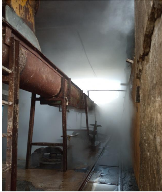
Figura 16. Vapor de flasheo Render al ingreso de las cocinas, parte superior Fuente: Elaboración propia.
