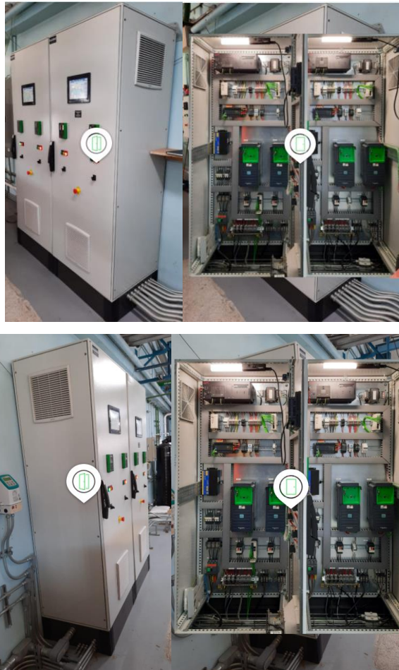
Figura 40. Escena y subescena del panel de control de las bombas visto desde los costados.
