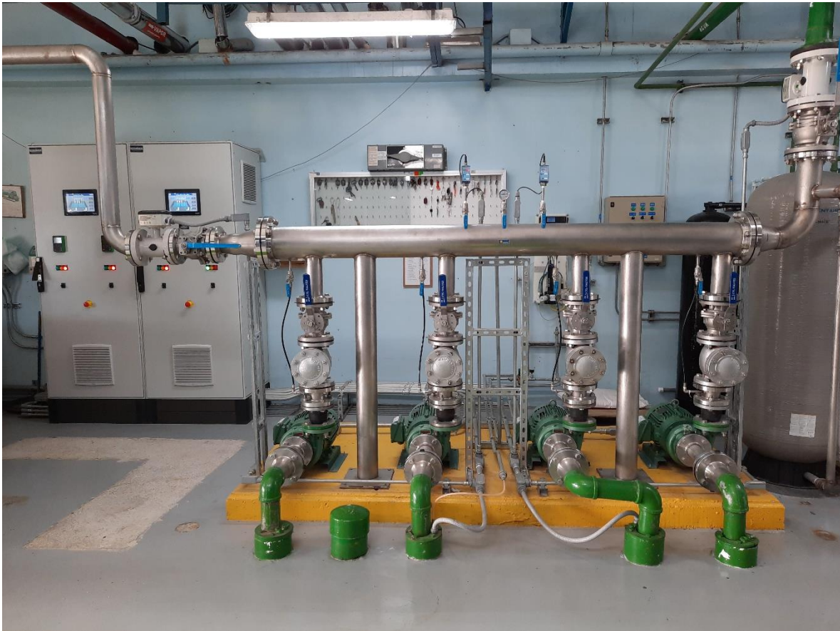
Figura 19. Sistema de bombeo del Hospital de San Carlos.
