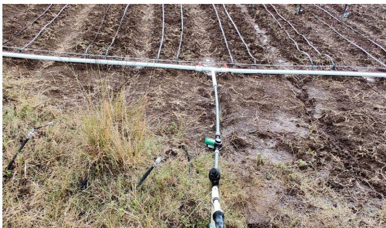
Figura 23. Tubería múltiple. Fuente propia.
