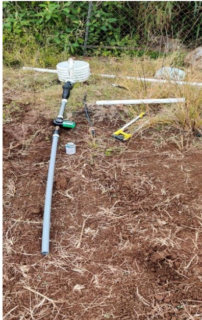
Figura 22. Tubería principal. Fuente Propia
