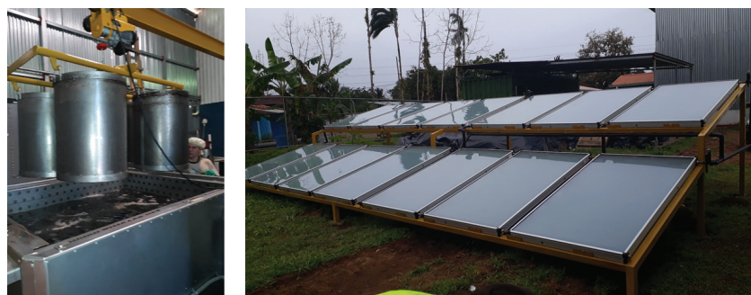
Figura 18. Sistema térmico solar híbrido forzado instalado en la planta procesadora de la Asociación de Productores de Pimienta de Sarapiquí para el escaldado de la pimienta verde.
