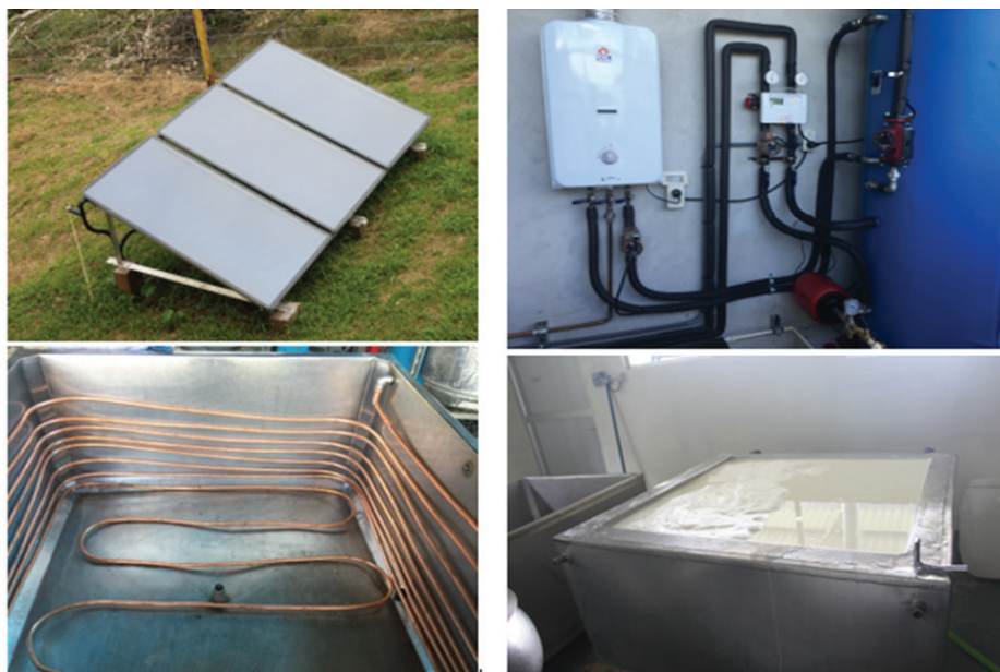
Figura 8. Detalle del sistema solar forzado híbrido con gas LP implementado en la planta procesadora de lácteos LLAFRAK. (A) . Sistema de colectores solares, ubicados a nivel del suelo, (B) Tanque para el almacenamiento y sistema de control de temperatura del agua, (C) Sistema de flujo del agua caliente (serpentines) para el intercambio de calor en la marmita recubierta (D).
