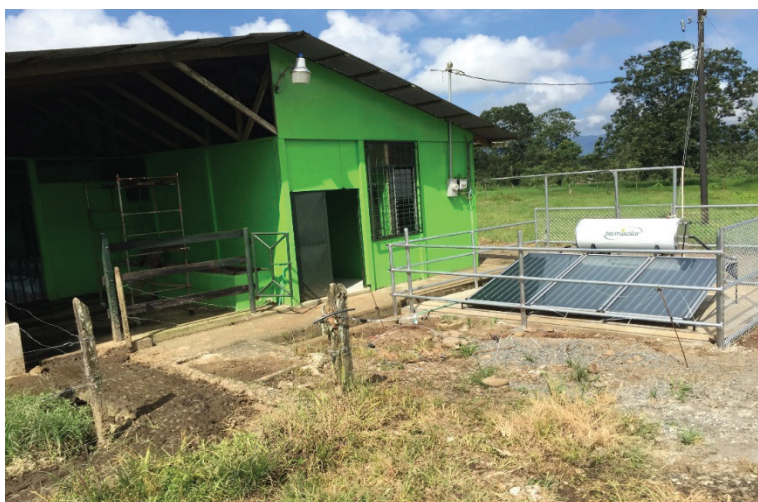
Figura 6. Sistema solar termosifónico híbrido implementado en la lechería de la Escuela Técnica Agrícola e Industrial (ETAI) en Santa Clara de San Carlos.
