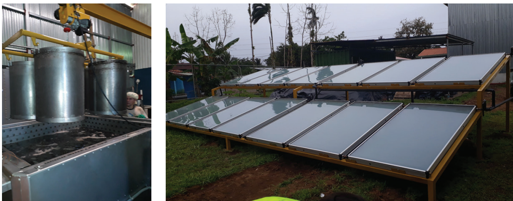
Figura 2. Sistema térmico solar híbrido forzado instalado en la planta procesadora de la Asociación de Productores de Pimienta de Sarapiquí para el escaldado de la pimienta verde. Fuente: Elaboración propia
