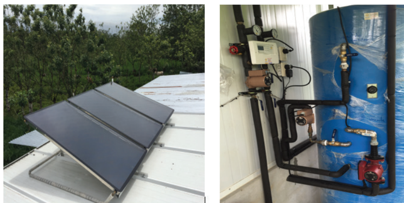
Figura 11. Sistema solar termosifónico forzado híbrido con sistema auxiliar de gas Lp implementado en la planta procesadora de lácteos San Bosco.
