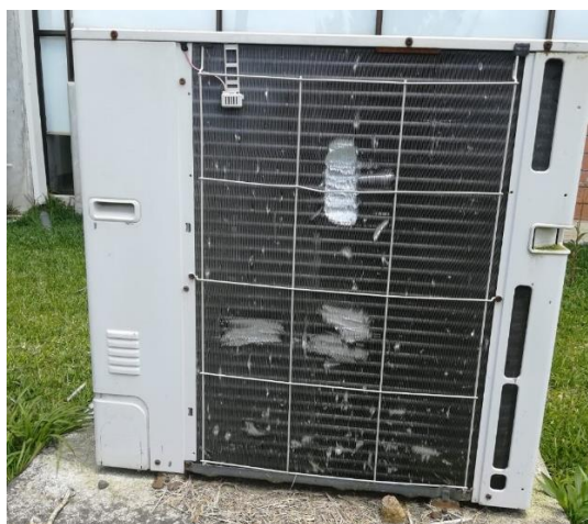
Figura 6-6 Golpes en el aletado del condensador.
