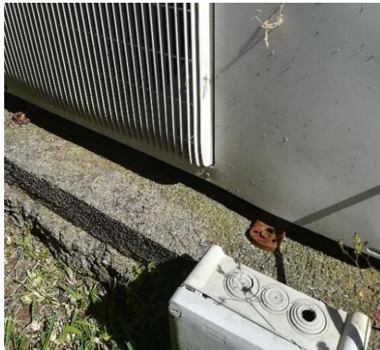
Figura 6-2 Equipo con oxidación en los sistemas de sujeción
