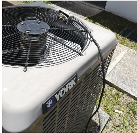
Figura 6-9 Equipo con tomacorriente expuesto
