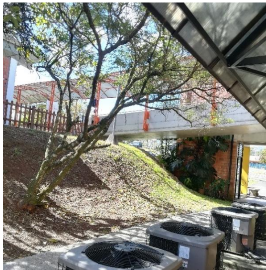
Figura 6-4 Equipos que acumulan hojas.
