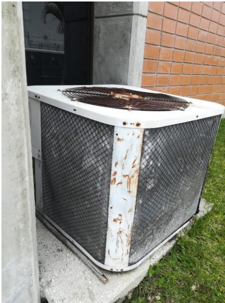
Figura 6-1 Equipo con oxidación ferrosa en la estructura.
