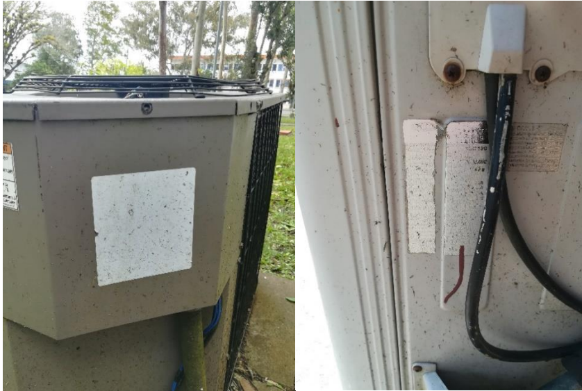
Figura 6-7 Datos de placa de los equipos dañada
