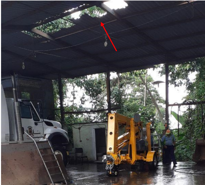
Figura 5.22 Malas condiciones del techo del sector de lavado de vehículos
