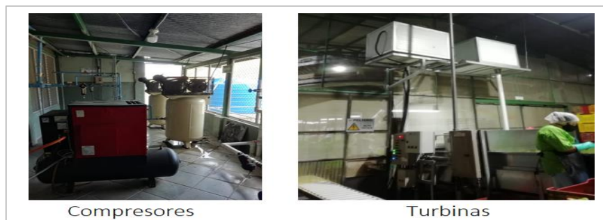
Figura IV-13. Compresores y turbinas elevadas en la planta de producción
